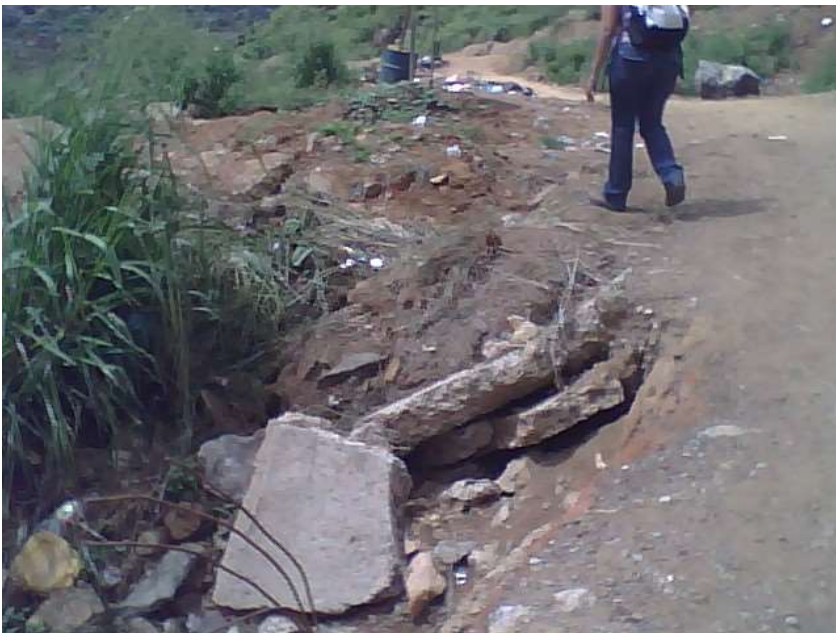
Figura N° 11: Deslizamiento por lluvias en parte de la vía principal de acceso a los Planes 5 y 6, Sector La Pedrera
