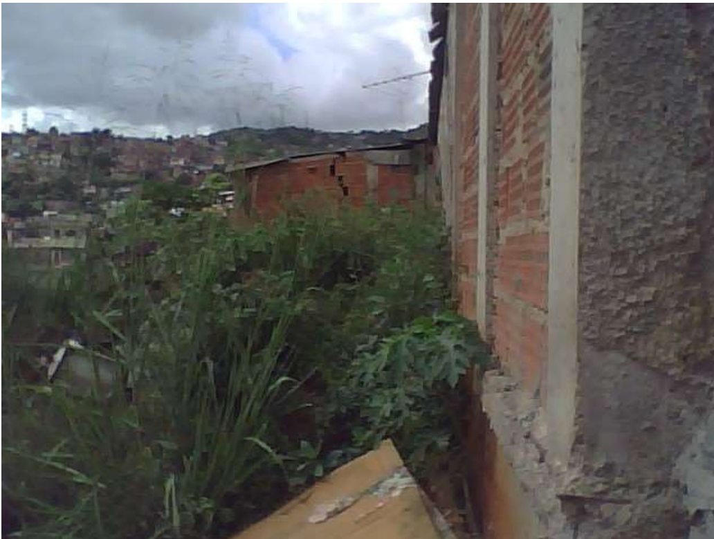
Figura N° 12: Vivienda afectada por movimiento de talud
