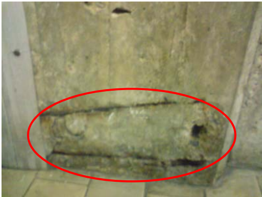
FIGURA IV.3.48 Foto 33 Falta de recubrimiento (3) Corrosión (4)
