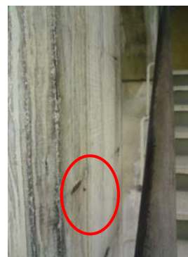
FIGURA IV.3.20 Foto 8 Falta de recubrimiento (5) Corrosión (5)
