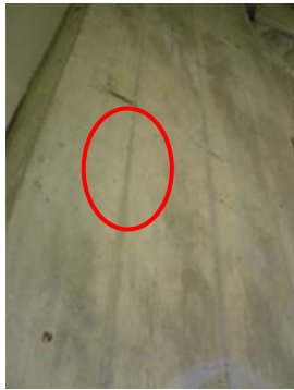
FIGURA IV.3.24 Foto 9 Falta de recubrimiento (5) Corrosión (5)
