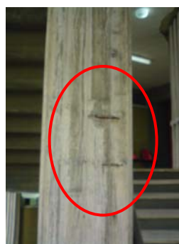
FIGURA IV.3.41 Foto 26 Falta de recubrimiento (4) Corrosión (4)
