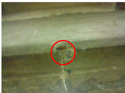
FIGURA IV.3.34 Foto 19 Falta de recubrimiento (2) Corrosión (2)
