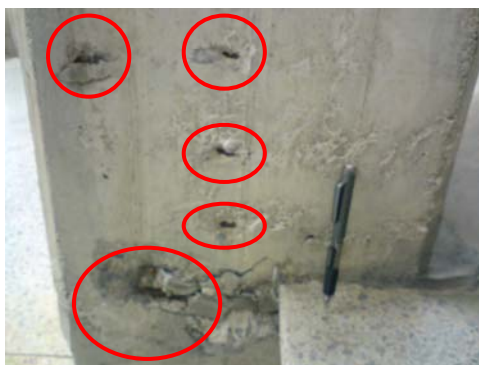
FIGURA IV.3.19 Foto 7 Falta de recubrimiento (5) Corrosión (5)
