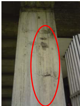
FIGURA IV.3.18 Foto 1 Falta de recubrimiento (2) Corrosión (3)
