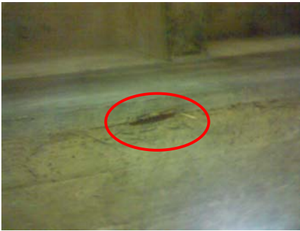
FIGURA IV.3.30 Foto 15 Falta de recubrimiento (2) Corrosión (2) Poros (2)
