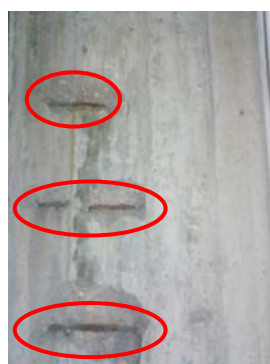
FIGURA IV.3.39 Foto 24 Falta de recubrimiento (4) Corrosión (4)
