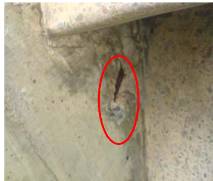
FIGURA IV.3.23 Foto 6 Falta de recubrimiento (5) Corrosión (5)
