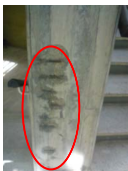
FIGURA IV.3.40 Foto 25 Falta de recubrimiento (4) Corrosión (4)
