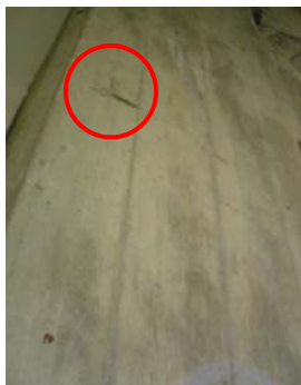
FIGURA IV.3.28 Foto 13 Falta de recubrimiento (2) Corrosión (2) Poros (2)
