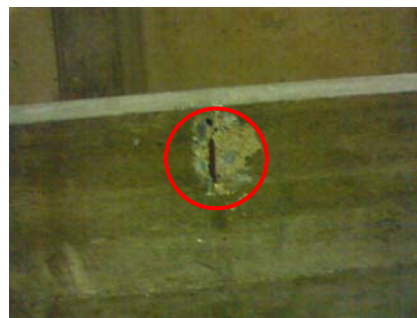
FIGURA IV.3.35 Foto 20 Falta de recubrimiento (2) Corrosión (2)
