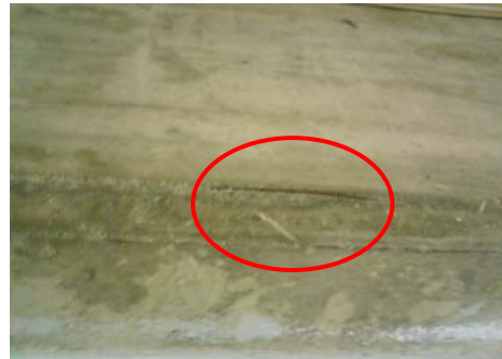
FIGURA IV.3.43 Foto 28 Falta de recubrimiento (1)
