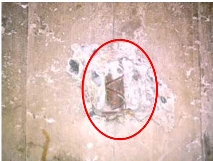
FIGURA IV.3.32 Foto 17 Falta de recubrimiento (3) Corrosión (3)
