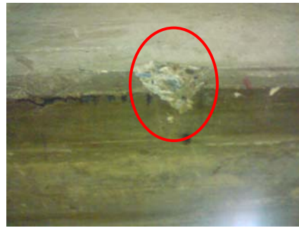
FIGURA IV.3.33 Foto 18 Falta de recubrimiento (2) Corrosión (2)
