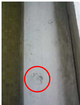
FIGURA IV.3.26 Foto 11 Falta de recubrimiento (1)
