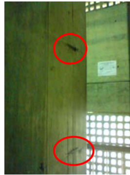
FIGURA IV.3.25 Foto 10 Falta de recubrimiento (2) Corrosión (2)
