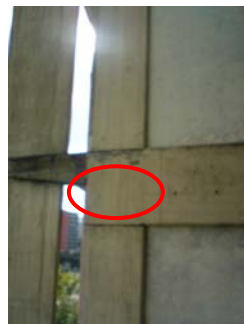
FIGURA IV.3.45 Foto 30 Falta de recubrimiento (3) Corrosión (3)
