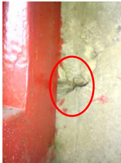
FIGURA IV.3.42 Foto 27 Falta de recubrimiento (2)
