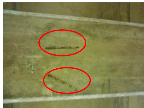
FIGURA IV.3.29 Foto 14 Falta de recubrimiento (2) Corrosión (2) Poros (2)
