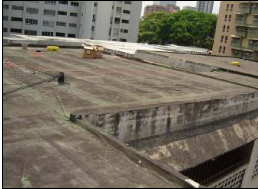
Figura A.31 – Nivel 4. Se observa el poco acceso que tiene dicho nivel; también se observan los equipos de medición usados por FUNVISIS en una visita realizada al plantel
