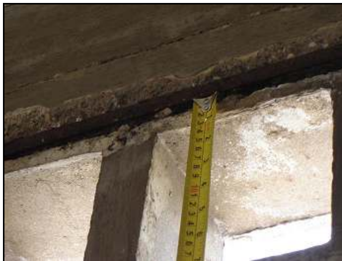
Figura V.18. Pared de ventilación del 3º piso, donde se pone en evidencia el refuerzo.
