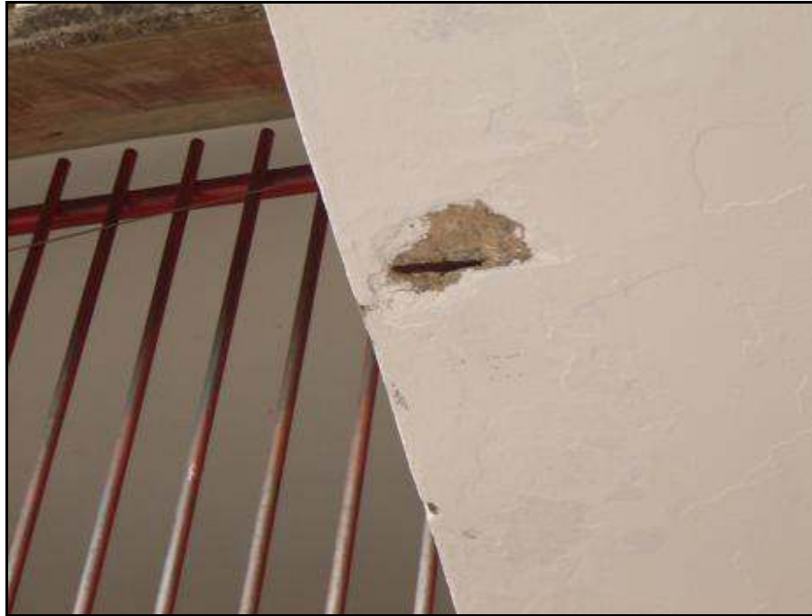
Figura A.25 – Grieta en la planta baja del Edificio Norte
