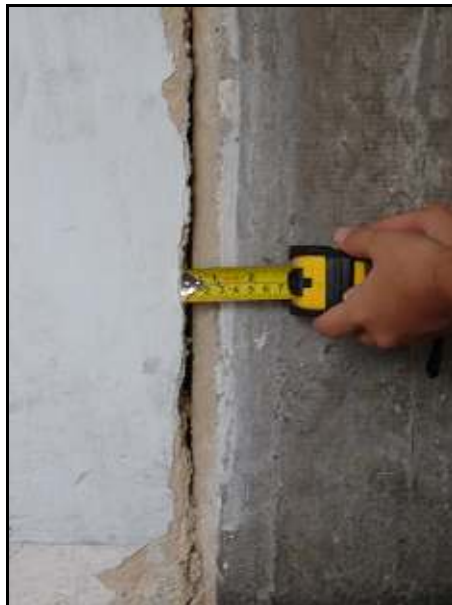
Figura IV.2. Junta de construcción entre el módulo de la escalera y el edificio Sur de la U. E. N. Padre Sojo. La imagen pertenece al último nivel donde puede observarse la separación que presenta dicha junta.
