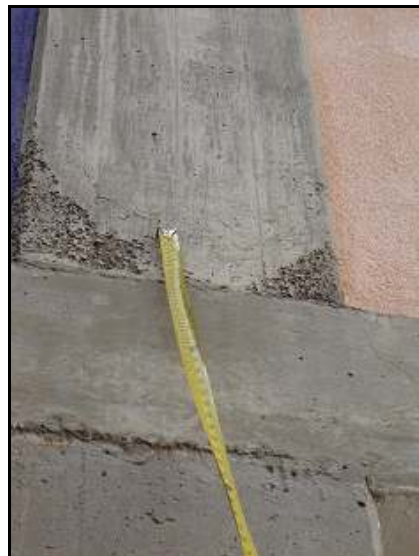
Figura V.21. Grietas en la columna que sostiene parte del volado del nivel 1 del Edificio Norte.
