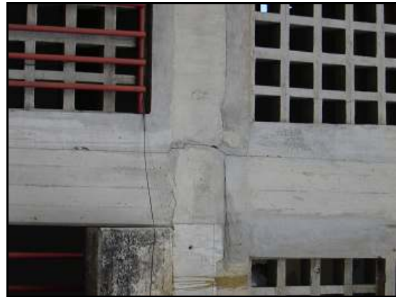
Figura V.22. Las tres imágenes fueron tomadas desde el patio central hacia el módulo de la escalera. En ellas se aprecian las grietas causadas por la separación natural a nivel de las juntas de construcción, por medio de las cuales se mantienen unidos los 3 edificios.
