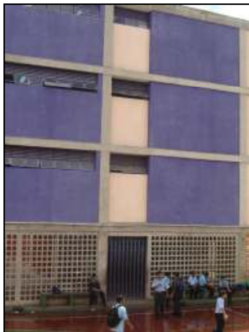
Figura A.28 – Fachada Norte. Se observa la presencia de columnas cortas en los niveles superiores
