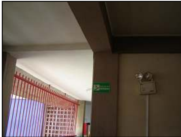
Figura V.9. Imagen tomada desde el Módulo de la escalera hacia el edificio Sur, donde se aprecian las vigas altas en ambas direcciones y la columna C4.
