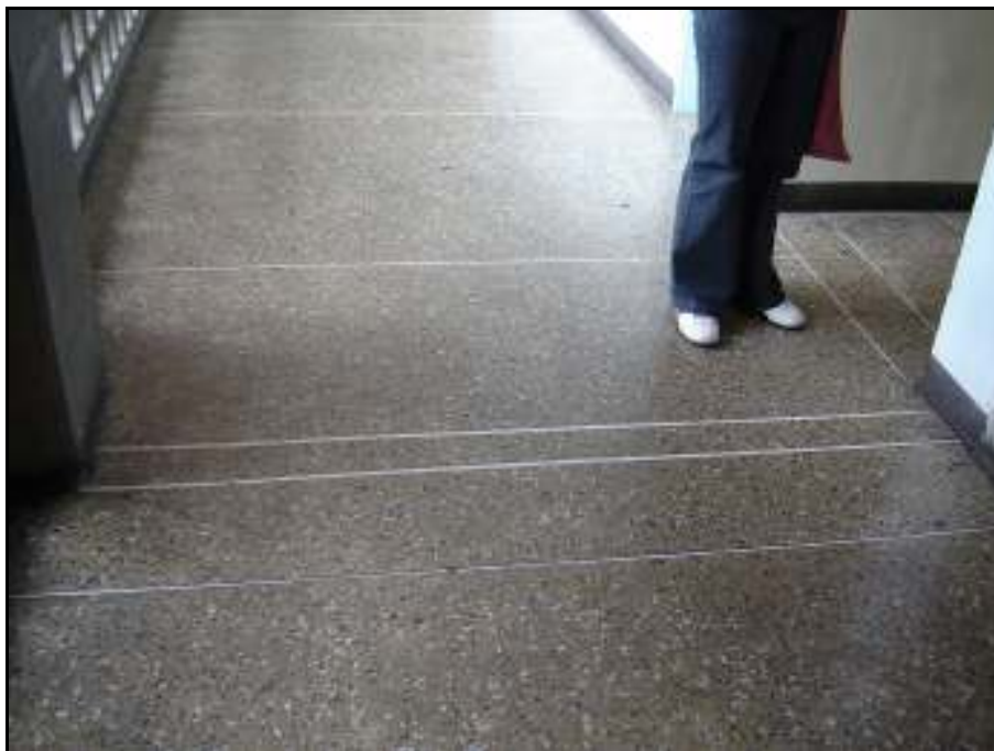
Figura A.18 – Junta en el nivel 1 (Edificio Sur)
