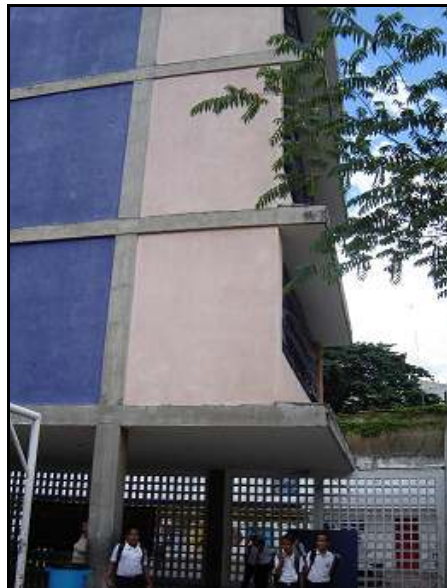
Figura V.19. Edificio Norte, el cual presenta grietas en el volado del nivel 1 y en la columna que sostiene dicho volado.
