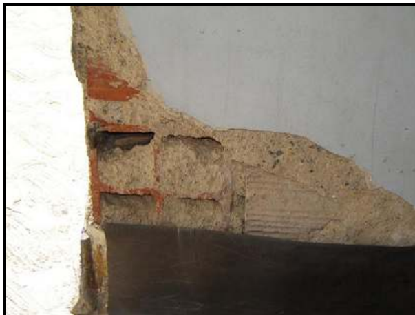
Figura V.17. Tabiquería constituida por bloques de arcilla. Imagen tomada en la fachada Sur, entrada principal de la U. E. N. Padre Sojo.
