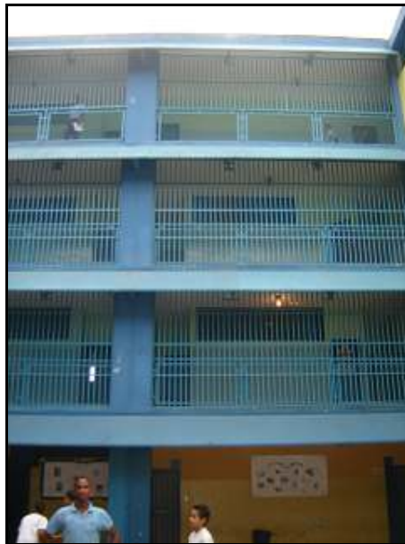
Figura IV.14. Imagen tomada desde el patio central. Se observa la junta entre las columnas de 45 cm. x 45 cm. y las rejas de ventilación con parasoles metálicos.
