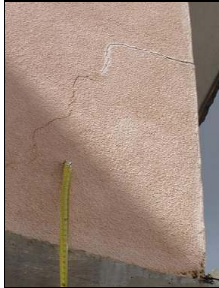
Figura V.20. Grieta en el volado del nivel 1 del Edificio Norte.
