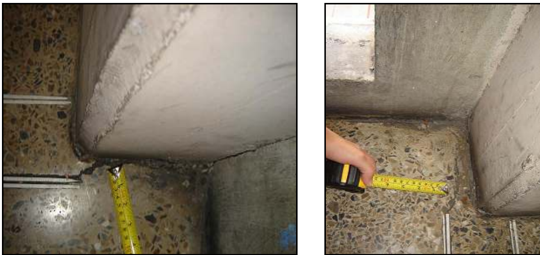
Figura V.23. A la izquierda se observa la junta del Edificio Norte y a la derecha la junta del Edificio Sur en la parte superior de la losa del nivel 1
