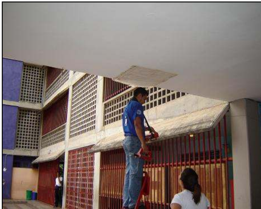
Figura A.26 – Se observa el técnico del IMME tomando una imagen con el detector de metales en el lugar de la grieta mostrada en la Imagen anterior
