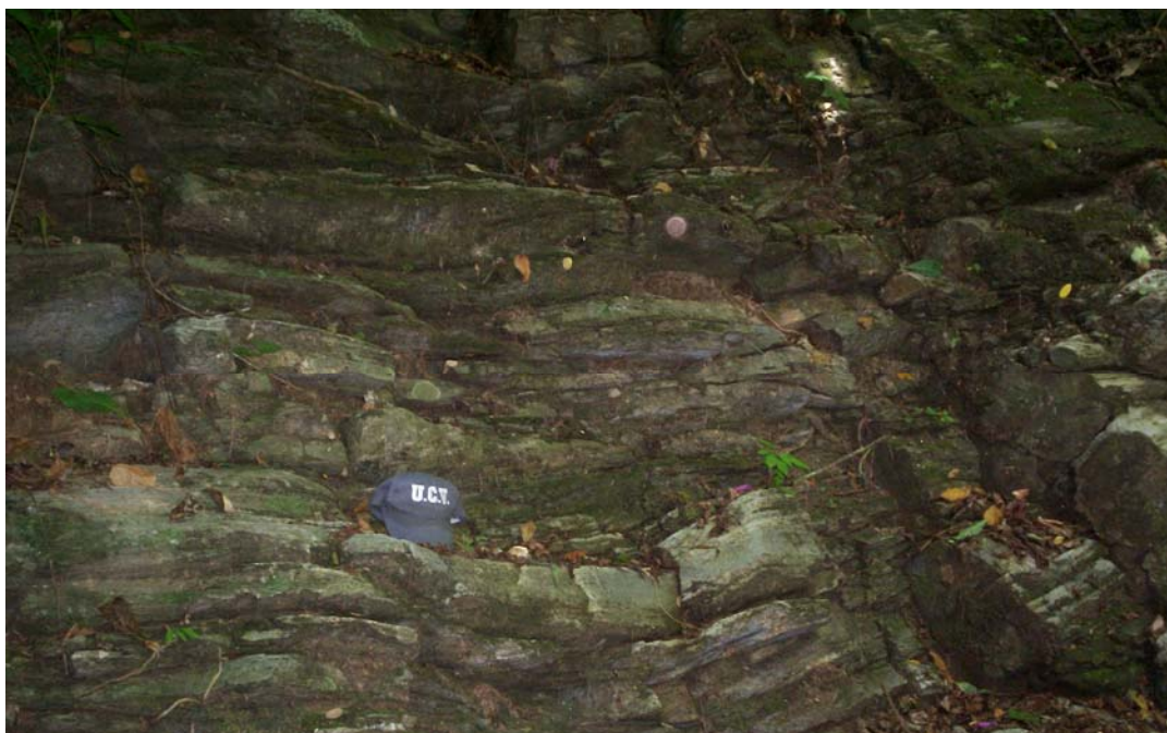
Figura #37. Evidencia de la foliación y diaclasas en la quebrada QDY, perteneciente al sector #2 (S2) del túnel Caucagüita.
