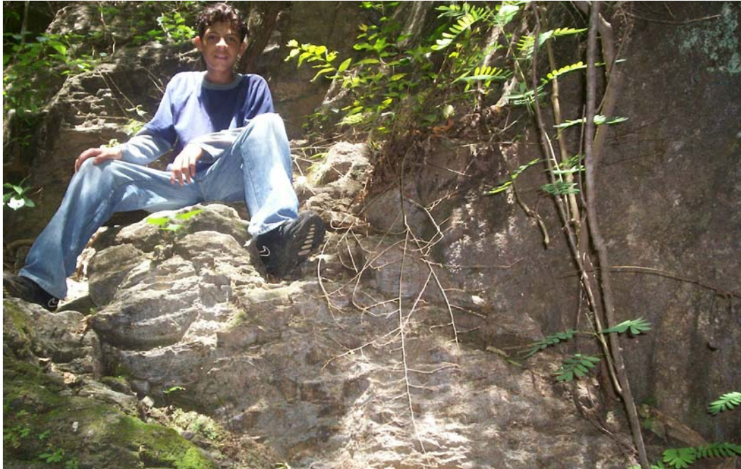
Figura #39. Evidencia de la foliación y diaclasas en la quebrada GUAR, perteneciente al sector #3 (S3) del túnel Caucagüita.
