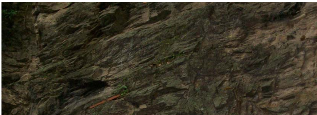
Figura #36. Evidencia de la foliación y diaclasas en la quebrada Placer, perteneciente al sector #2 (S2) del túnel Caucagüita.
