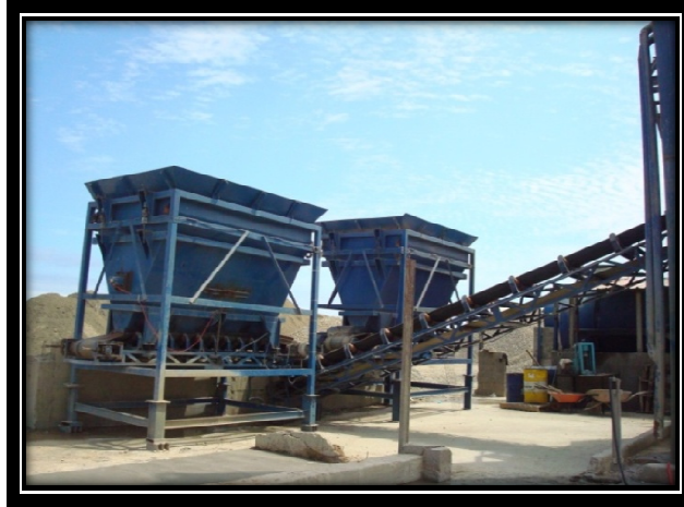
Imagen III.1.- Planta de Premezclado Rapid Concreto
