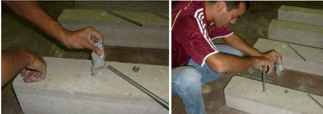
Figura III.53: Barras roscadas de acero SAE Grado 2 de \frac{1}{2} " de diámetro adheridas a viguetas para caracterización del epóxico.
