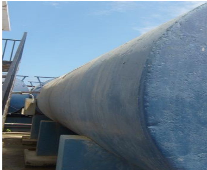
Figura III.2: Tanque de agua dispuesta para la realización de mezclas ubicado en Planta Premezcladora Rapid Concreto.
