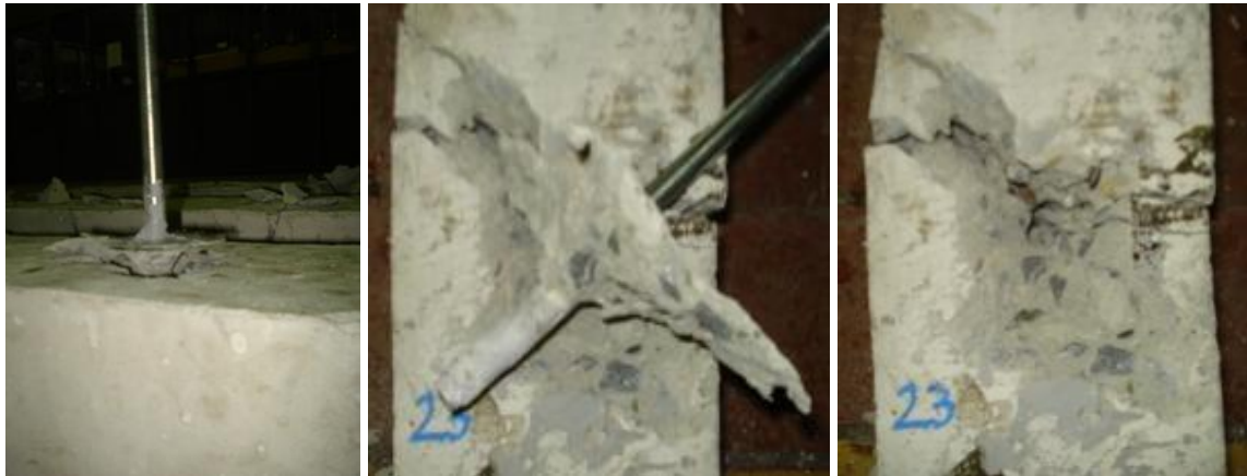
Figura III.64: Un tipo de Falla del Sistema de Anclaje.
