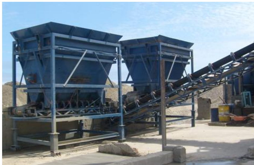
Figura III.4: Tanques de almacenamiento de piedra picada y arena ubicado en Planta Premezcladora Rapid Concreto.
