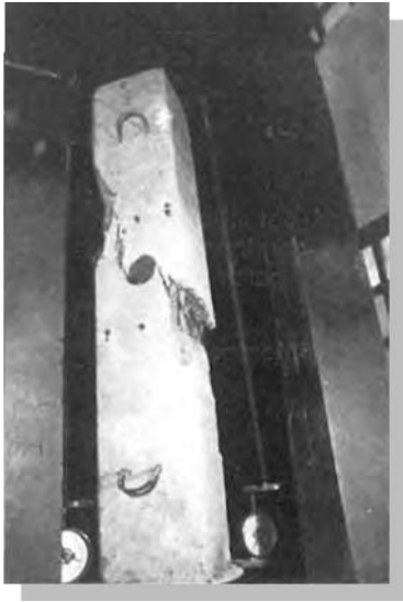
Imagen 3. Rotura típica de columna con extracción sin reparar. J. Calavera y G. Aparicio. 1975
