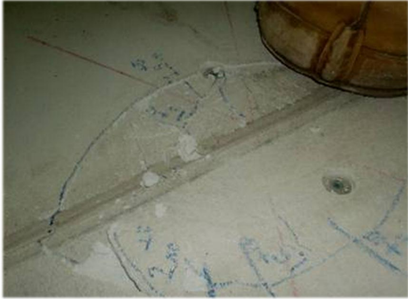
Foto No. 3: Ensayo de Impacto, falla por aplastamiento del recubrimiento (I)
