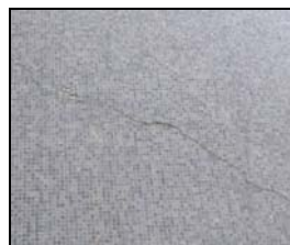
Figura 53 Grieta en Pared y caída de Mosaicos (Eje A 2-3)
