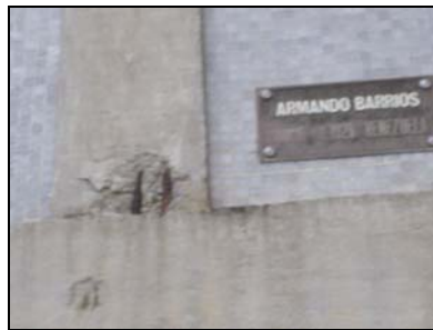
Figura 28 Barras de Refuerzo Expuestas en la Edificación
