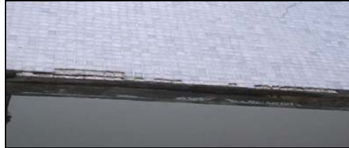
Figura 27 Desprendimiento de mosaicos en la Edificación
