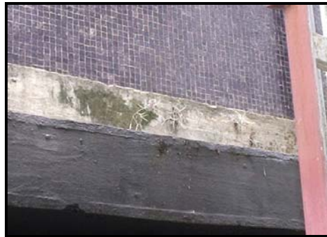
Figura 24 Crecimiento Vegetal en la Edificación
