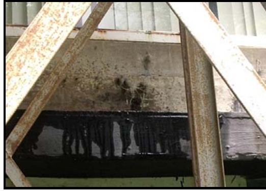
Figura 25 Filtración de Aires Acondicionados en la Edificación
