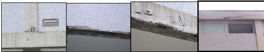
Figura 52 Algunos Refuerzos Expuestos en la Edificación. Ubicación de Izq. a Der: (Fachada Oeste. Machón C-6, Grieta en Fachada Este. Eje A 2-3, Fachada Este. Fachada Grieta A 12-13, Fachada Oeste. Eje D 7-8 )
