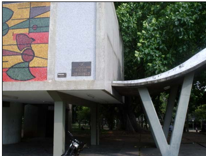
Figura A.5.2 Detalle de la unión del techo con forma de concha y el edificio
