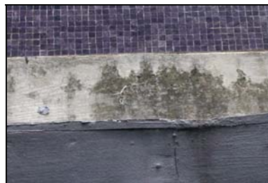
Figura 26 Manchas por humedad en la Edificación
