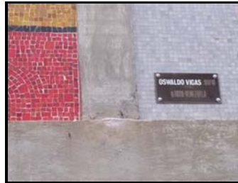
Figura 23 Escamado en la Edificación
