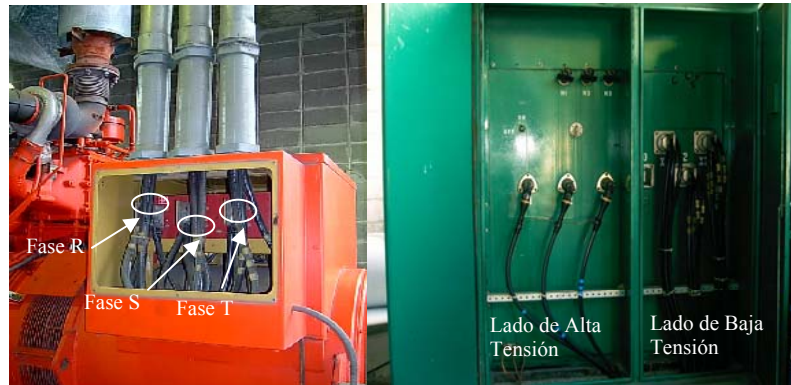
(b) Alimentador del generador (c) Alimentador del transformador
