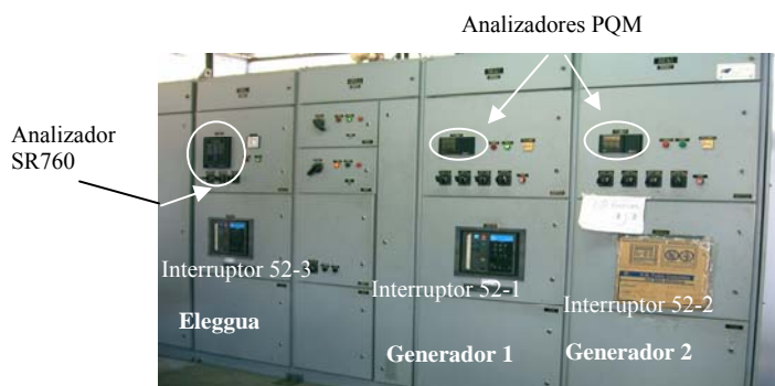
(a) Tablero de distribución principal T-G
