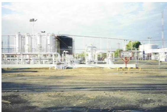
Figura 1: Sistema de Tratamiento
