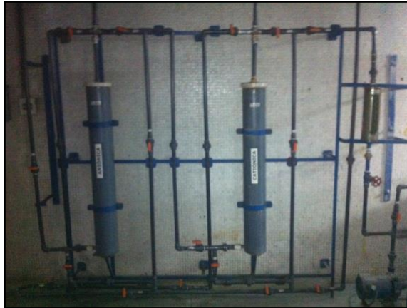
Figura 28. Planta Desmineralizadora de Agua.
