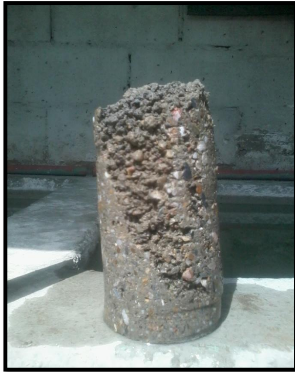
Anexo 15. Núcleo en mala condición.
