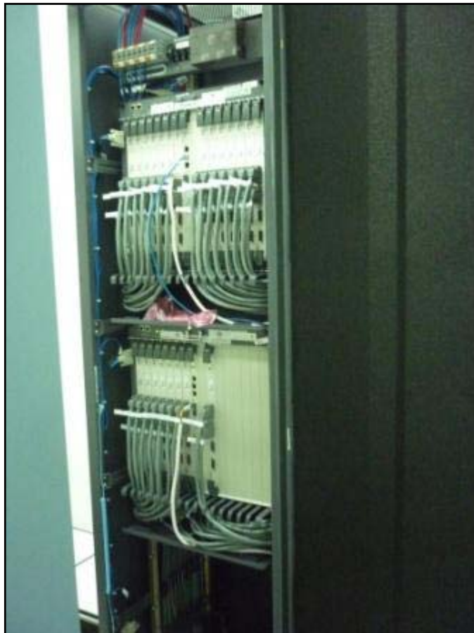
Figura 26 Vista del bastidor equipo MA5600.
