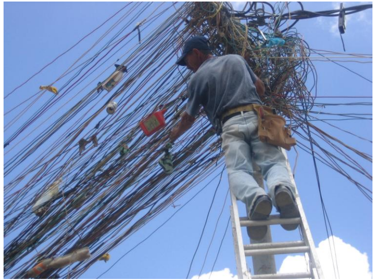
Anexo # 10: Parte del tendido eléctrico de la Comunidad Simón Rodríguez
