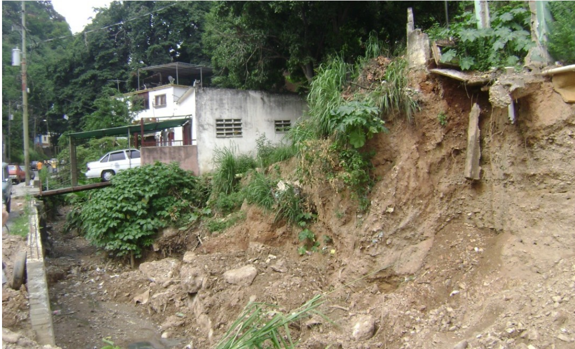
Figura 2.14. Quebrada Guacarapa. La construcción de viviendas y pasarelas en el lecho, ocasionó que este se expandiera provocando el aumento de la socavación lateral debido a la deflexión de un flujo torrencial, ocurrido durante el año 2008.
