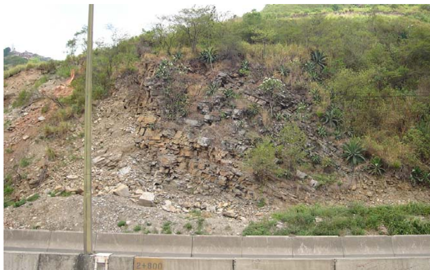
Figura 6.6.- Afloramiento en la progresiva 2+800; se observan los bloques de calizas bastante fracturadas con buzamiento de la foliación en el mismo sentido de la ladera y dos sistemas de diaclasas ortogonales entre sí.
