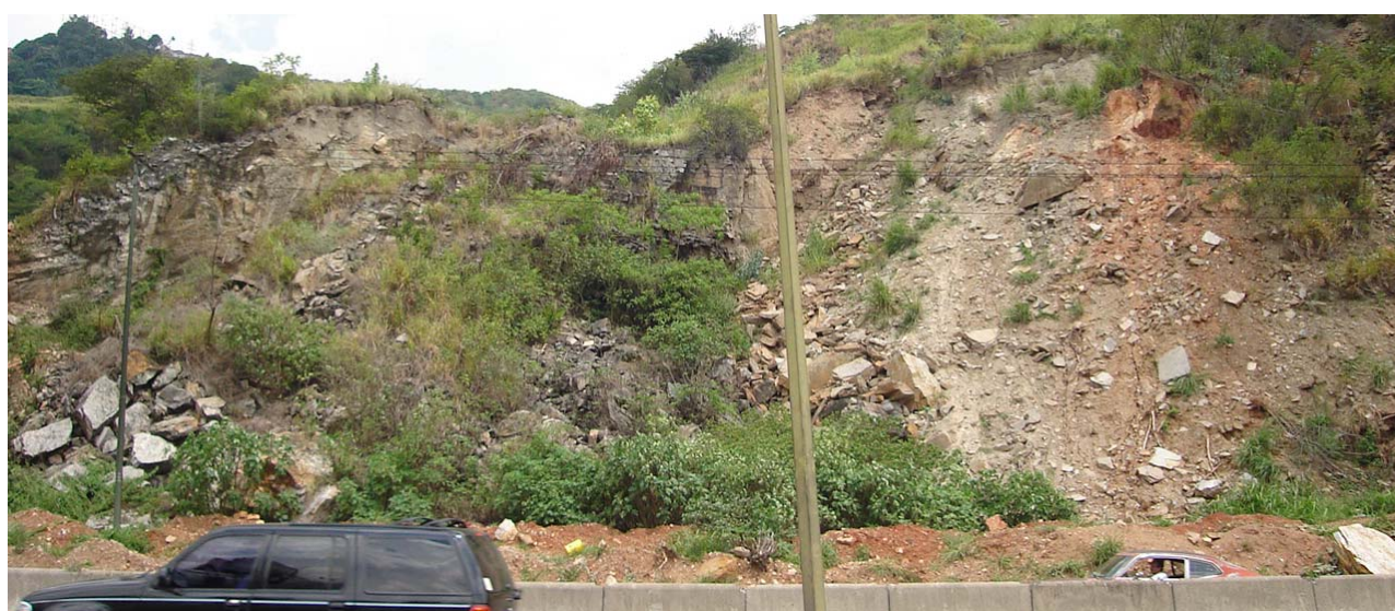
Figura 6.7.- Zona de caída de bloques en la progresiva 2+700
