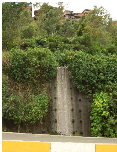
Figura 6.19. - Pantalla autopista, se observa la caída de agua por sobre la pantalla
