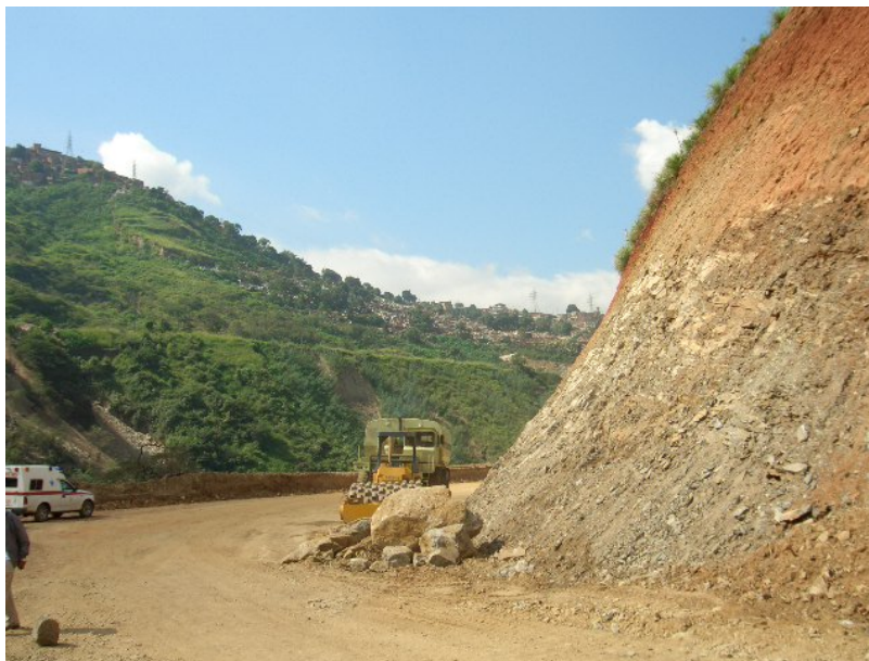
Figura 6.8. - Tramo en construcción de la vía de contingencia en la ladera norte del valle de Tacagua Se observan desprendimientos de bloques en los cortes realizados con pendiente igual a 0.5:1
