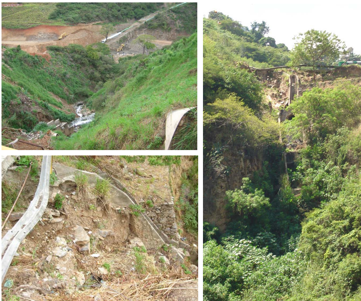
Figura 6.5.- Torrentera ubicada en la progresiva 2+600, se observa que se ha erosionado la ladera provocando problemas en la base del terraplén de la autopista
