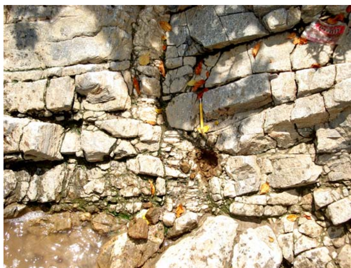
Figura 4.9.- Mármol fracturado, se evidencia la forma de bloques formados por la intercepción de tres orientaciones de planos de discontinuidad sub-ortogonales entre sí
