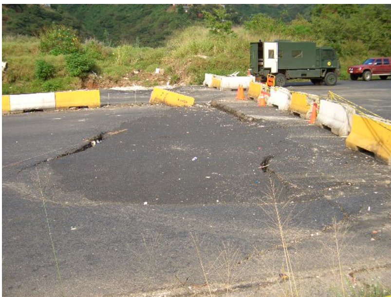
Figura 6.37.- Límite este del deslizamiento actual en progresiva 3+020 se observa el hundimiento de la capa asfáltica a lo largo de la vía.
