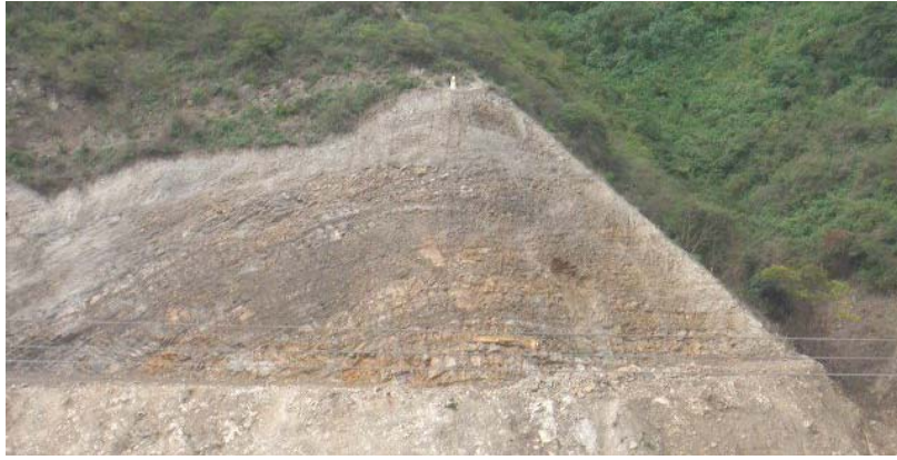
Figura 4.28.- Afloramiento de un enorme anticlinal amplio a 100 metros al este del estribo norte del Viaducto No 1, Producido por el corte 0,5:1 realizado para el paso de la vía de emergencia (Rumbo de foto N5°E)
