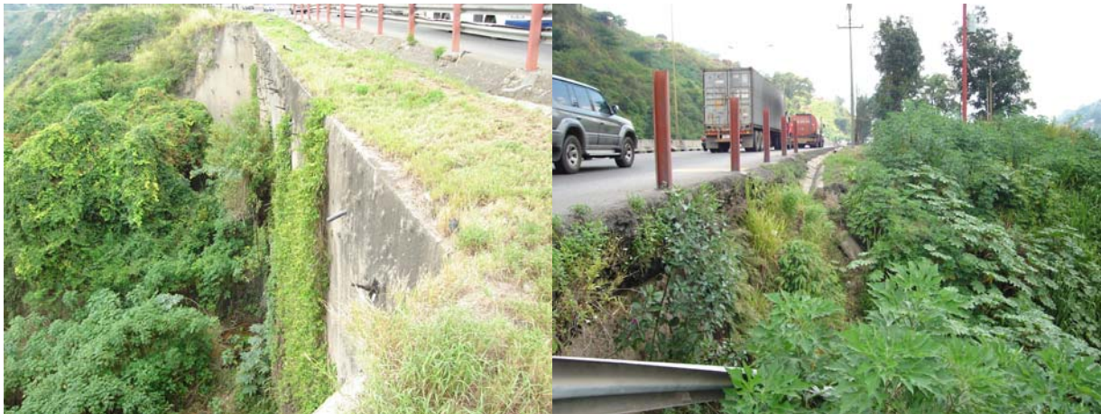
Figura 6.4.- Izquierda.- Pantalla atirantada construida en le progresiva 1+700, los drenes están tapados y el agua sale por un hueco de la pantalla Derecha.- Existen agrietamientos del asfalto debido al desprendimiento del material de la base del terraplén, progresiva 1+800
