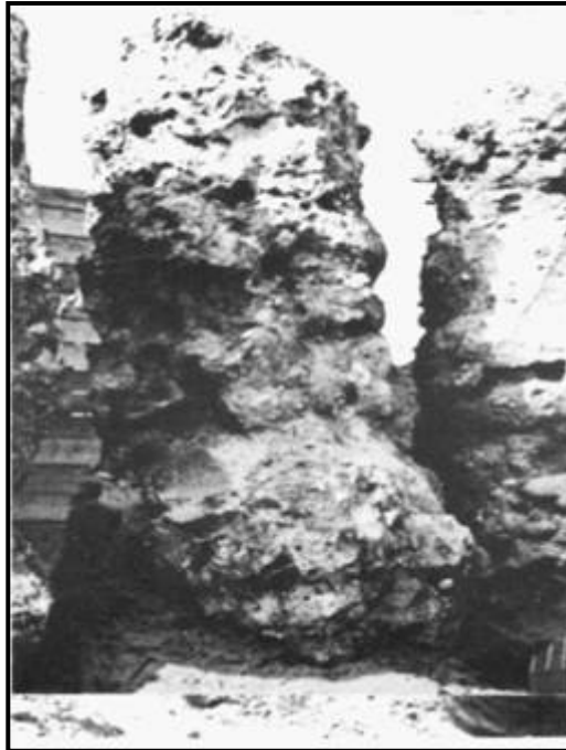
Fig.4.4. Columnas de CCP descubiertas.
