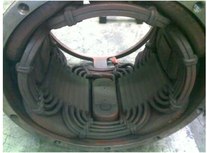
Fotografía 6: Detalle bobinas estáticas del motor de tracción. [Fuente: el autor]
