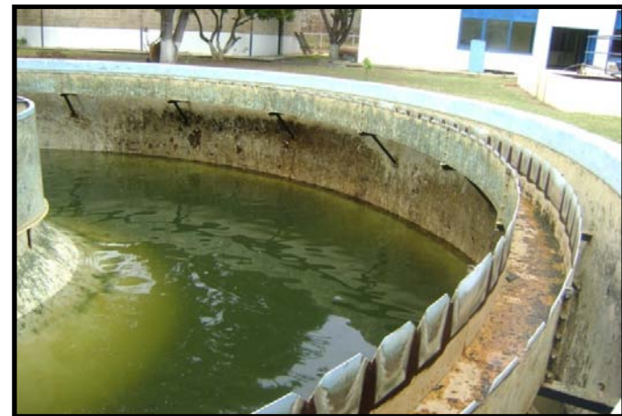
Figura III.20 Lavado de Acelerator tipo “IS”. Planta Potabilizadora Sistema Aislado Camatagua, Camatagua. Edo. Aragua.
