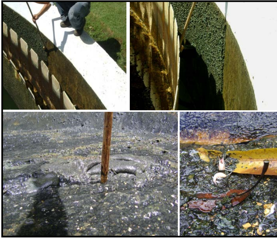
Figura III.15 Lavado de los decantadores Accelator tipo “IS”.
