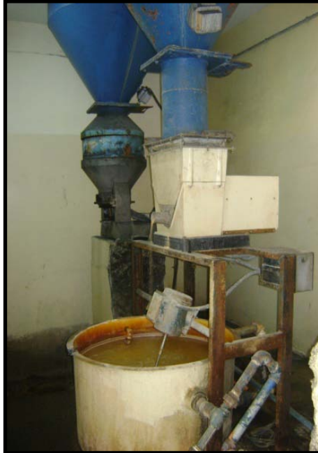
Figura II.7 Dosificador de sulfato de aluminio. Planta Potabilizadora Sistema Aislado Camatagua.
