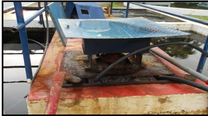
Figura III.11 Dosificación de sustancias químicas a la arqueta- Planta Potabilizadora Sistema Aislado de Camatagua.
