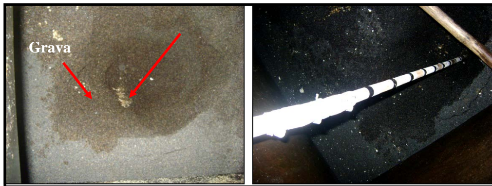
Figura III.24 Lecho filtrante de la batería de filtros. Planta Potabilizadora Sistema Aislado Camatagua, Camatagua. Edo. Aragua.
