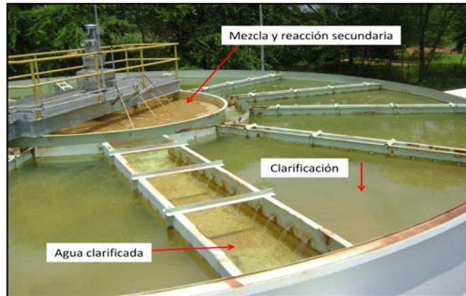
Figura III.17 Acelerator tipo “NS”. Planta Potabilizadora Santa Clara, Clarines. Edo. Anzoátegui.
