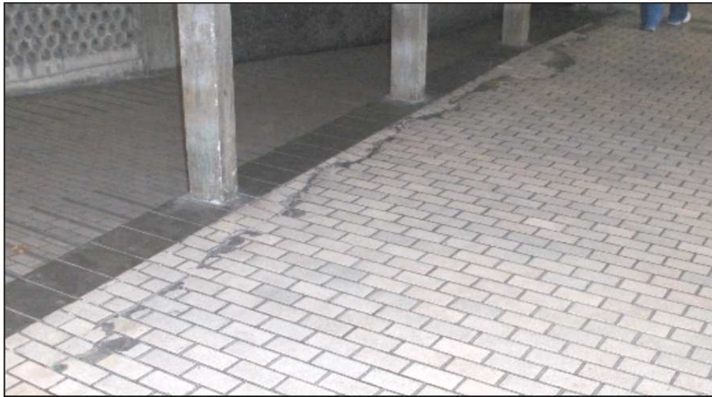
Figura 5.15. Fotografía de la grieta en el piso cerca de la biblioteca de la Facultad de Farmacia PB. Fotografía: Castillo, 2007.
