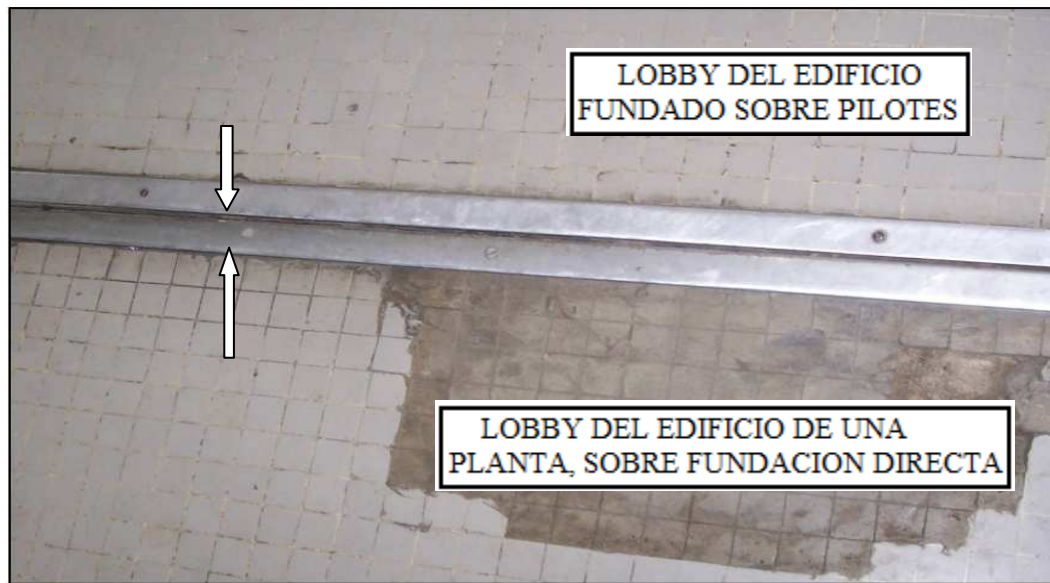
Figura 5.18. Entrada principal a la Facultad de Arquitectura y Urbanismo, en el lobby donde se observan el desnivel entre la junta de ambas edificaciones señalados por las flechas. Fotografía: Ramos, 2010.
