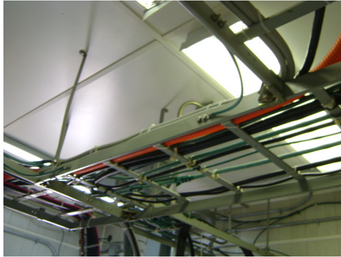
Figura 31. Recorrido de fibra óptica dentro del Shelter
