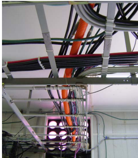
Figura 32. Recorrido de energía y fibra óptica dentro del Shelter
