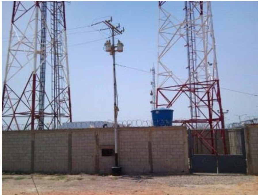
Figura 24. Vista general de la radio base Cardón
