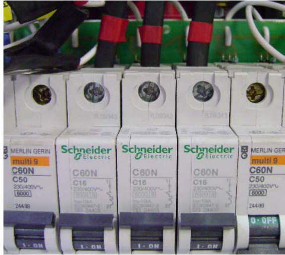
Figura 29. Breakers instalados para alimentar las RRUs
