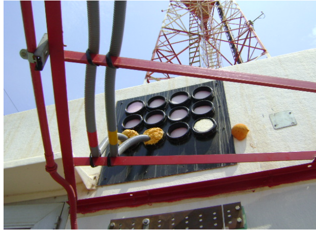
Figura 35. Recorrido de energía y fibra óptica en escalerilla horizontal
