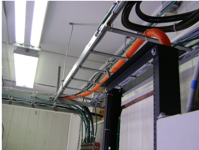
Figura 30. Recorrido de fibra óptica dentro del Shelter
