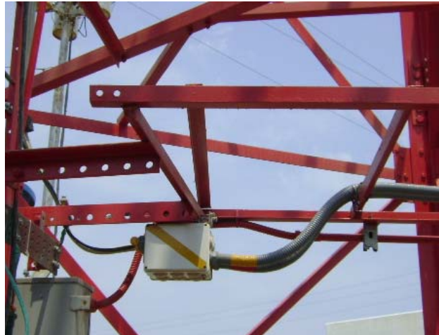
Figura 37. Caja de paso instalada para fibra óptica
