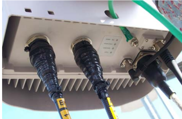
Figura 44. Detalle de conexiones de RRU
