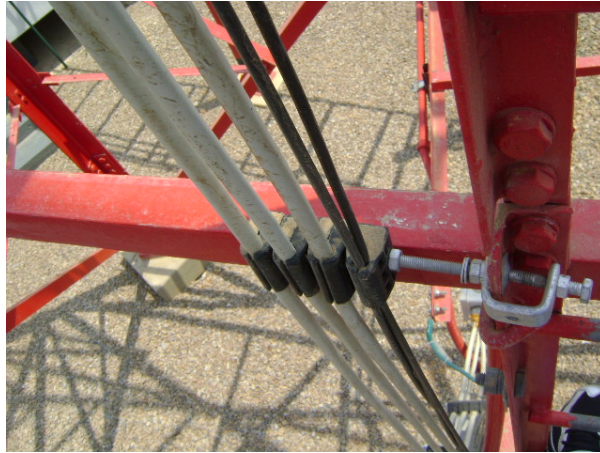
Figura 41. Grapas de 10mm para sujetar cableado vertical
