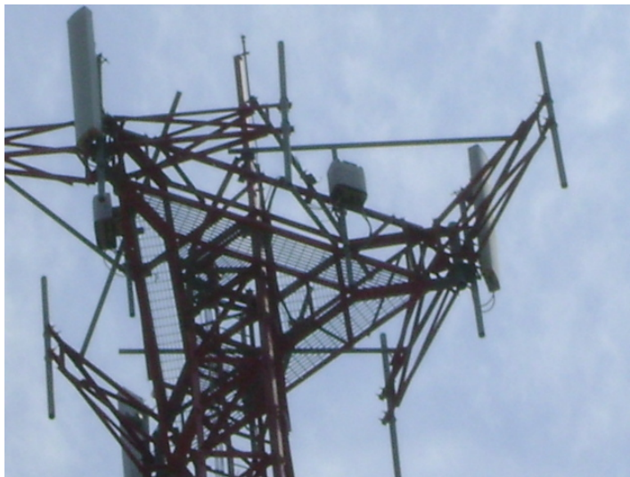
Figura 42. Sistema radiante instalado
