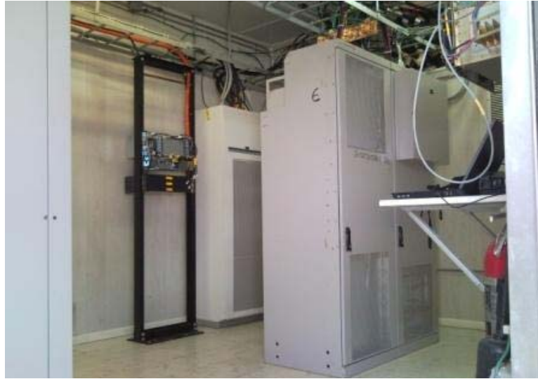
Figura 27. Vista general del rack instalado
