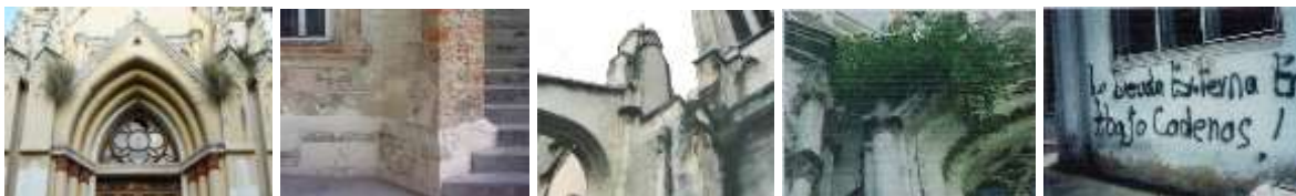
Figuras 2.a, 2.b, 2.c, 2.d, 2.e: Problemas conservativos en muros y columnas
