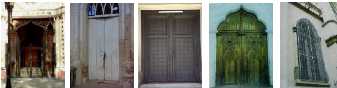
Figuras 4.a, 4.b, 4.c, 4.d, 4.e: Problemas conservativos en cerramientos.
