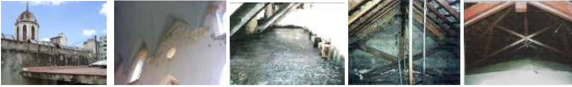
Figuras 1.a, 1.b, 1.c, 1.d y 1.e: Problemas conservativos en techos.
