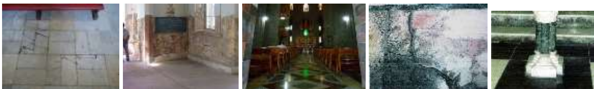
Figuras 3.a, 3.b, 3.c, 3.d, 3.e: Problemas conservativos en pavimentos.
