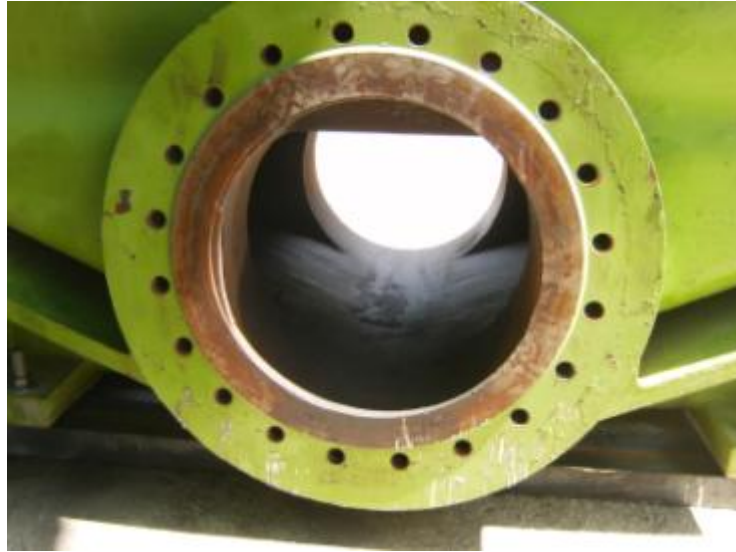
Figura 1-2. Carcasa de la bomba P3001
