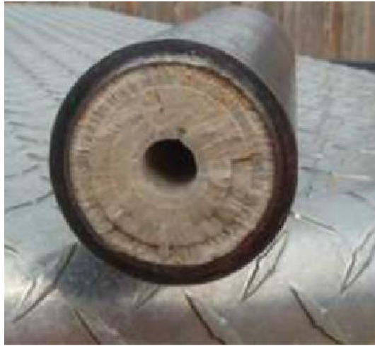
Figura 2.27 Problemas con incrustaciones en líneas de flujo. Tomado de PETROBRAS, 2008.
