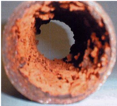
Figura 2.28 Línea de flujo afectada por la corrosión. Tomado de PETROBRAS, 2008.
