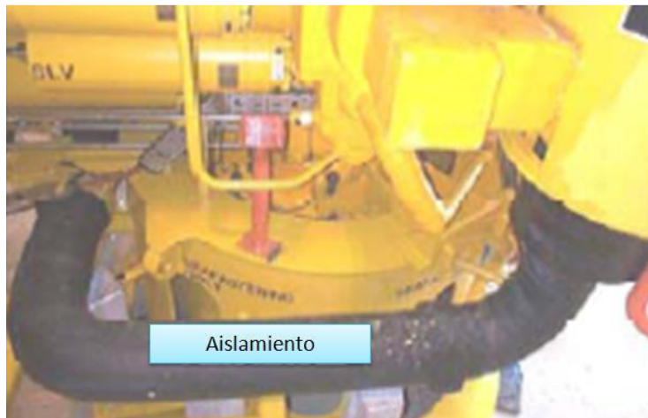
Figura 2.34 Ejemplo de aislamiento en una tubería. Tomado de PEMEX, 2012.
