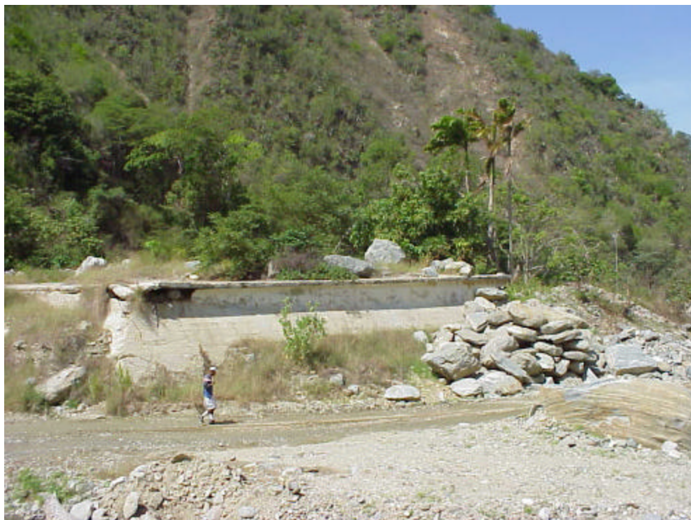
Figura 55 Tanque de almacenamiento de agua, aguas arriba de la población de Macuto.
