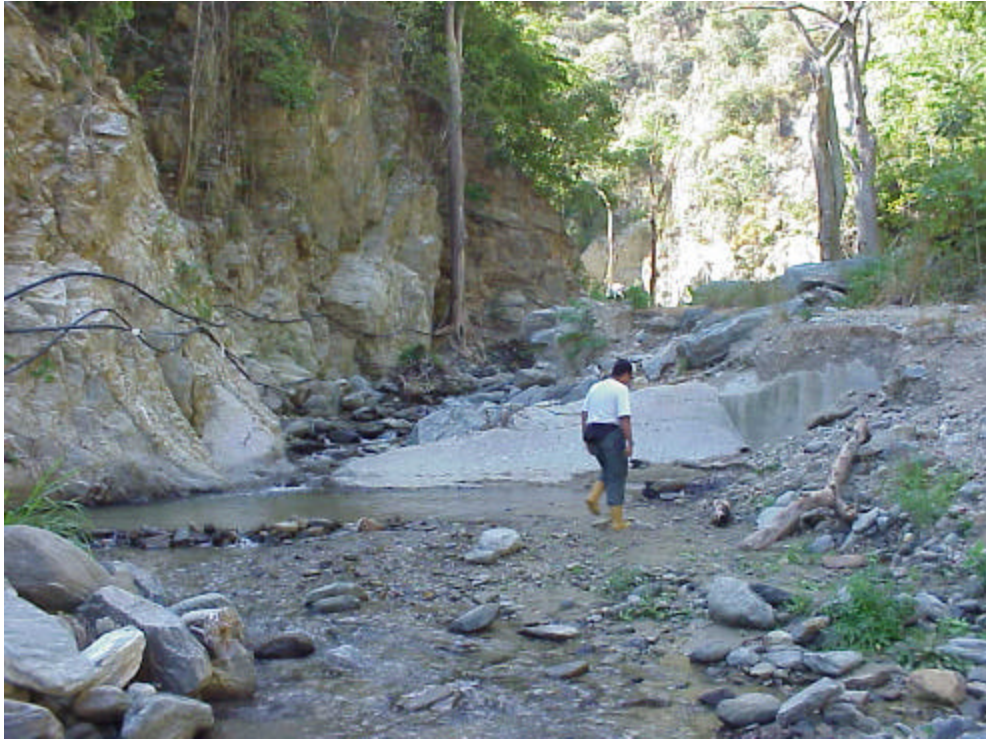
Figura 6 Dique toma destruido aguas arriba de la población de Macuto. Febrero 2001
