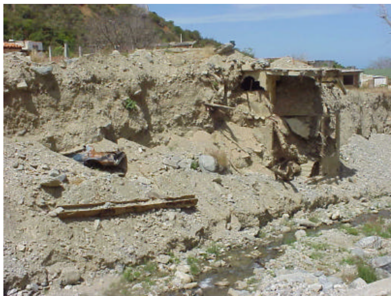
Figura 33 Depósitos de sedimentos en el cauce excavado.
