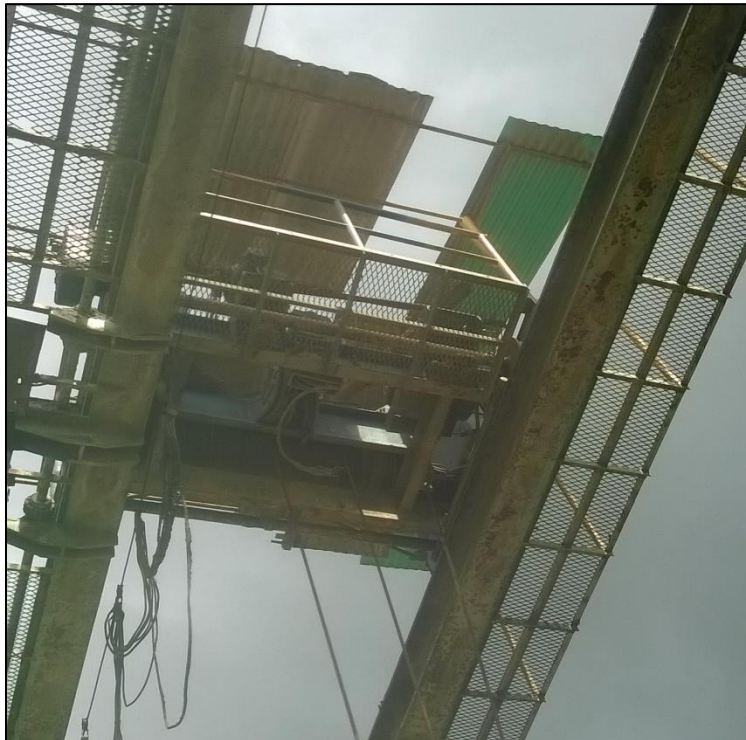
Figura 23 – Mal estado del techado puente grúa, Fuente: Elaboración propia
