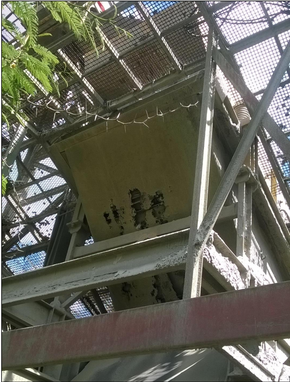
Figura 25 - Deterioro de la estructura de planta II, Fuente: elaboración propia
