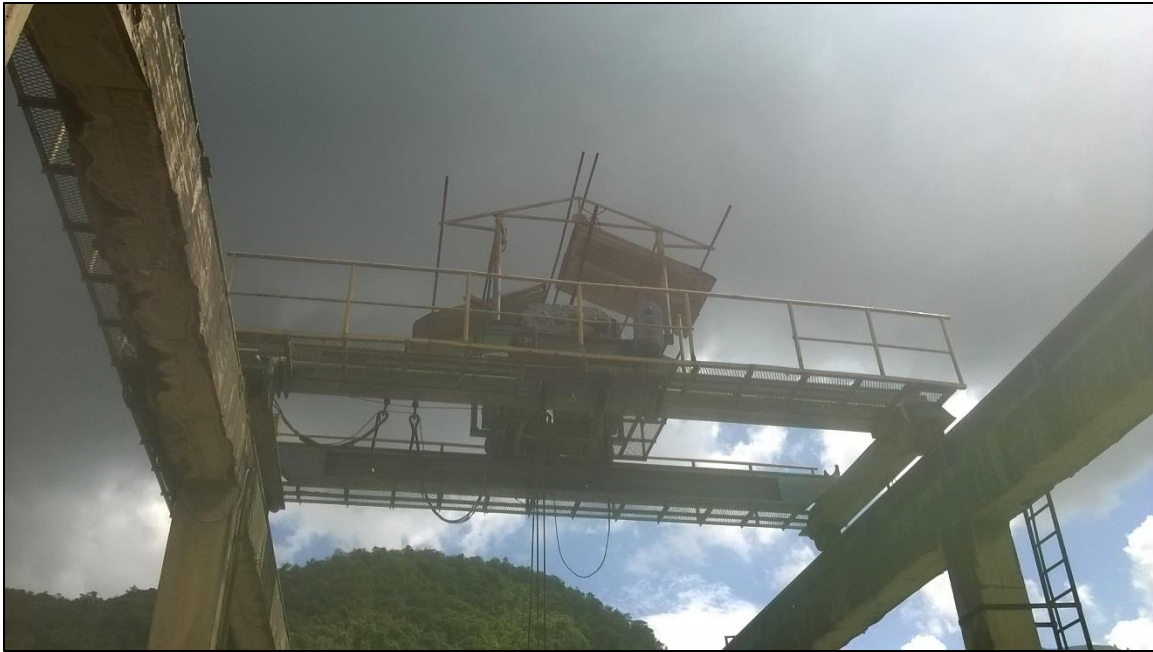
Figura 24 – Mal estado del techado de puente grúa, Fuente: Elaboración propia.
