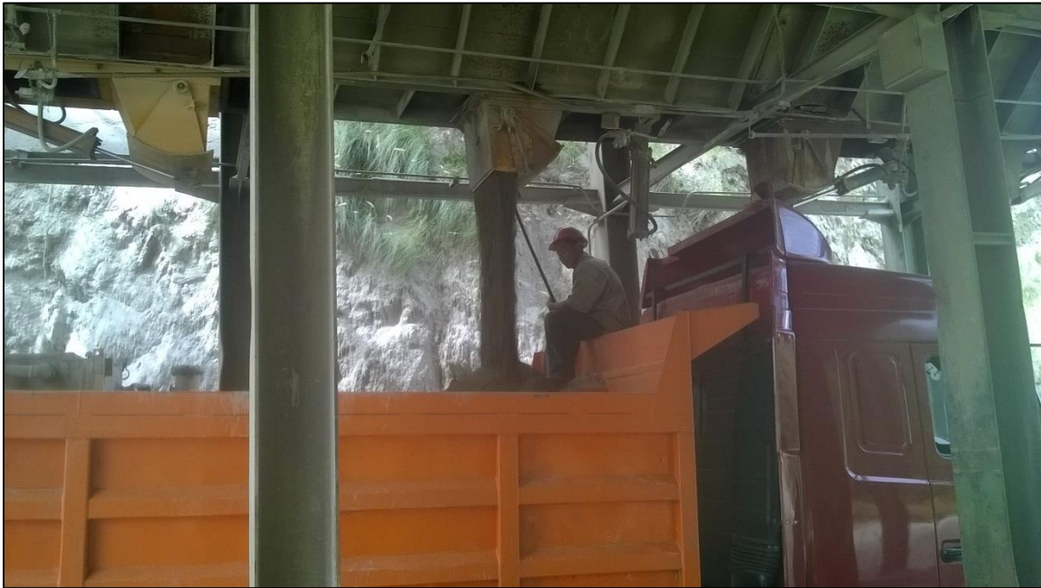
Figura 27 - Mal estado de brazos mecánicos, Fuente: Elaboración propia
