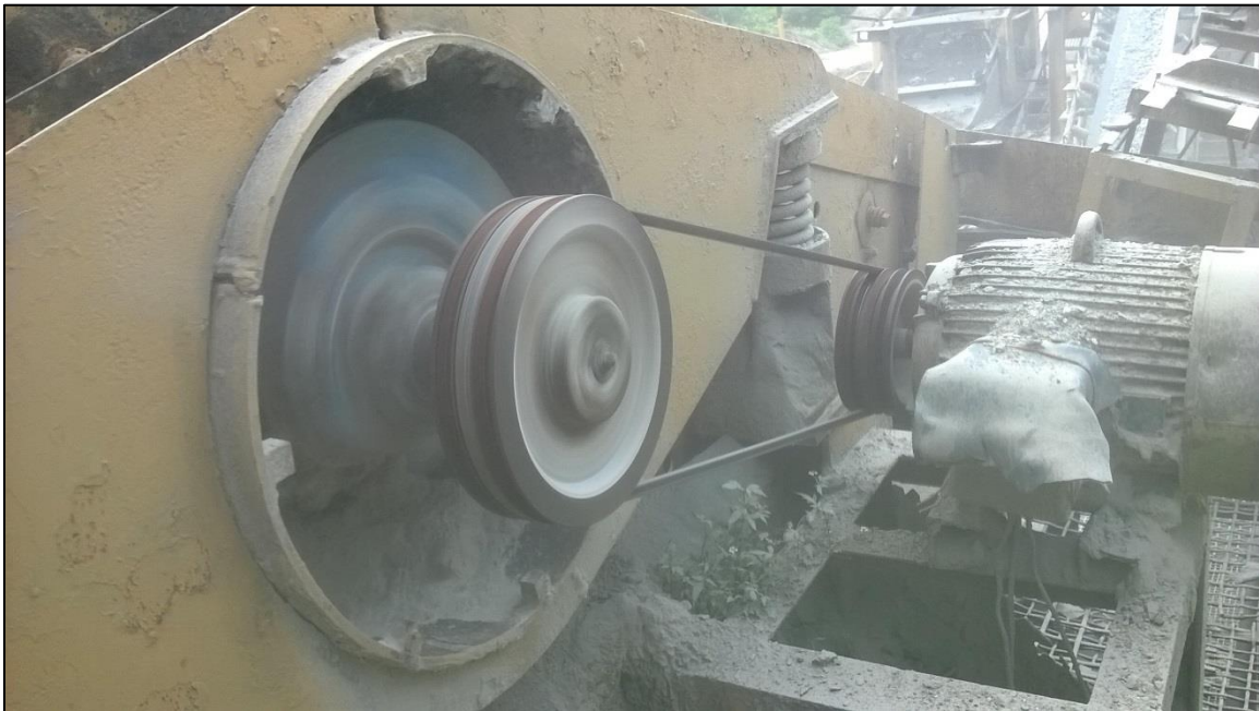
Figura 39 - Criba vibratoria 1 con falta de correas, Fuente: Elaboración propia
