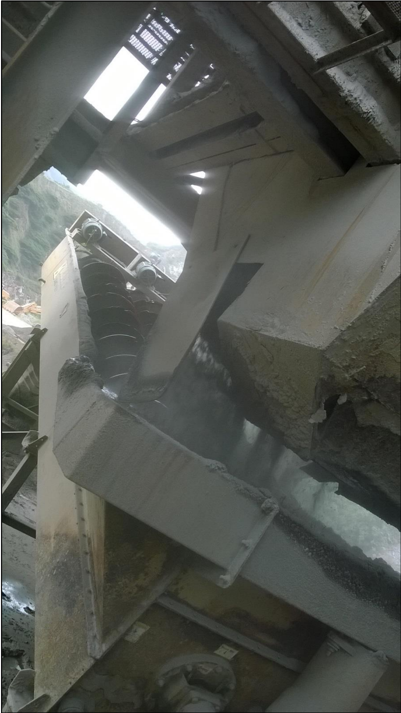
Figura 42 - Bajante que desemboca al tornillo lavador sin fin en mal estado y deterioro constante Fuente: Elaboración propia
