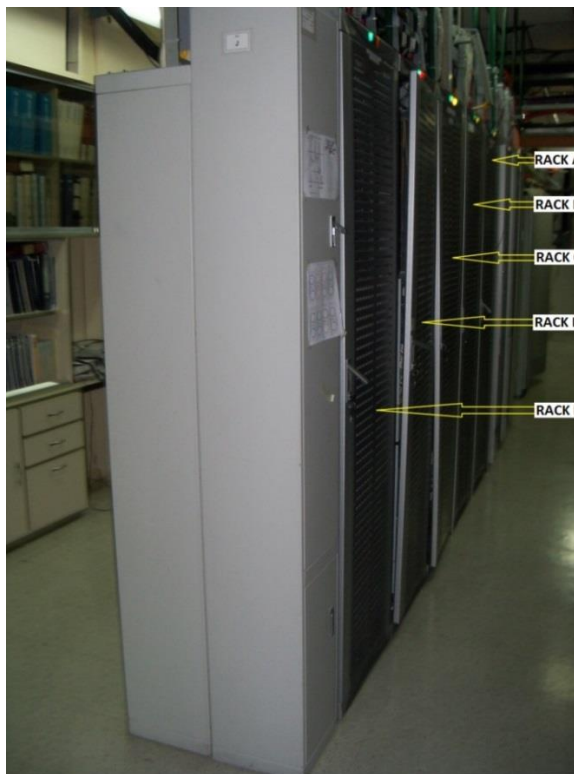
Figura 32. Rack para Equipos HUAWEI.
