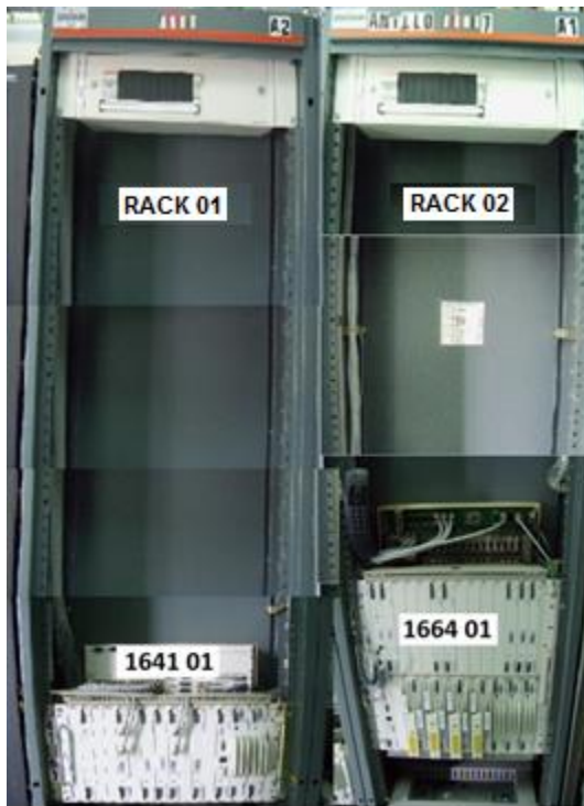
Figura 43. Vista Frontal del Rack 01 y 02.
