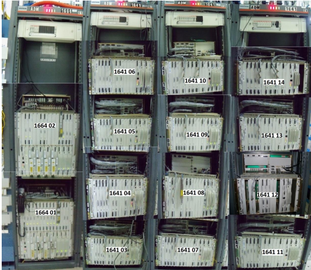
Figura 28. Vista Frontal Equipo ADM 1664 / 1641 ALCATEL.
