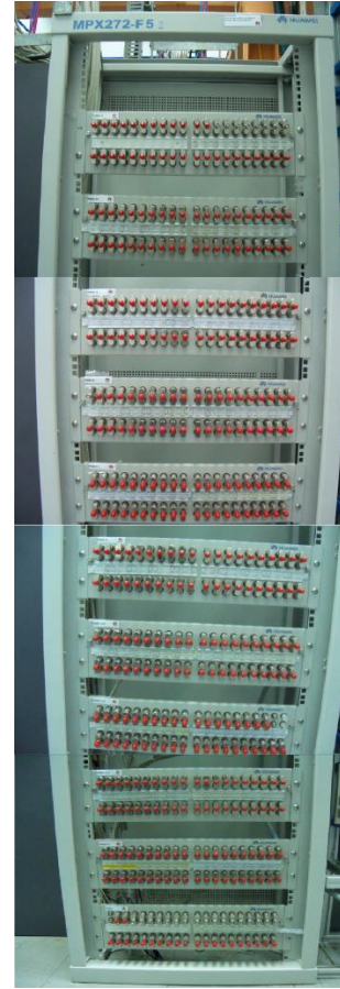
Figura 46. Rack DDF Huawei.
