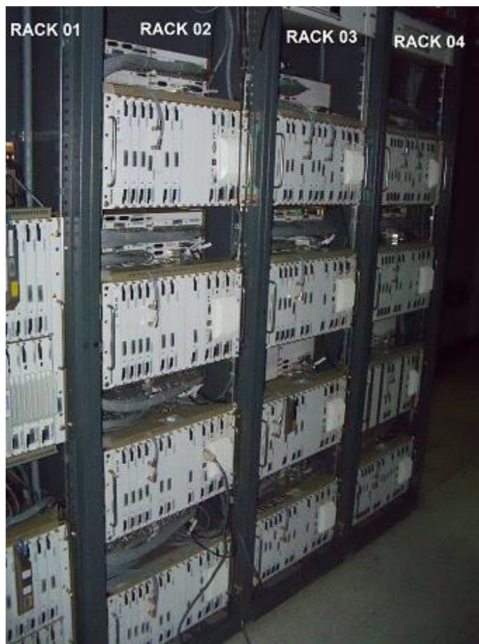
Figura 27. Vista General Equipos Alcatel SM 1641 y Alcatel SM 1664.
