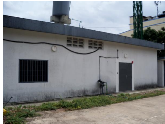
Figura 37. Sala de Transmisión San Juan de Colón.
