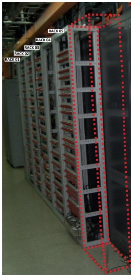
Figura 34. Rack DDF Huawei.
