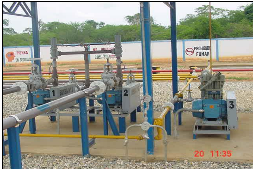
Foto N° 1 Sala de Bombas y Compresores
