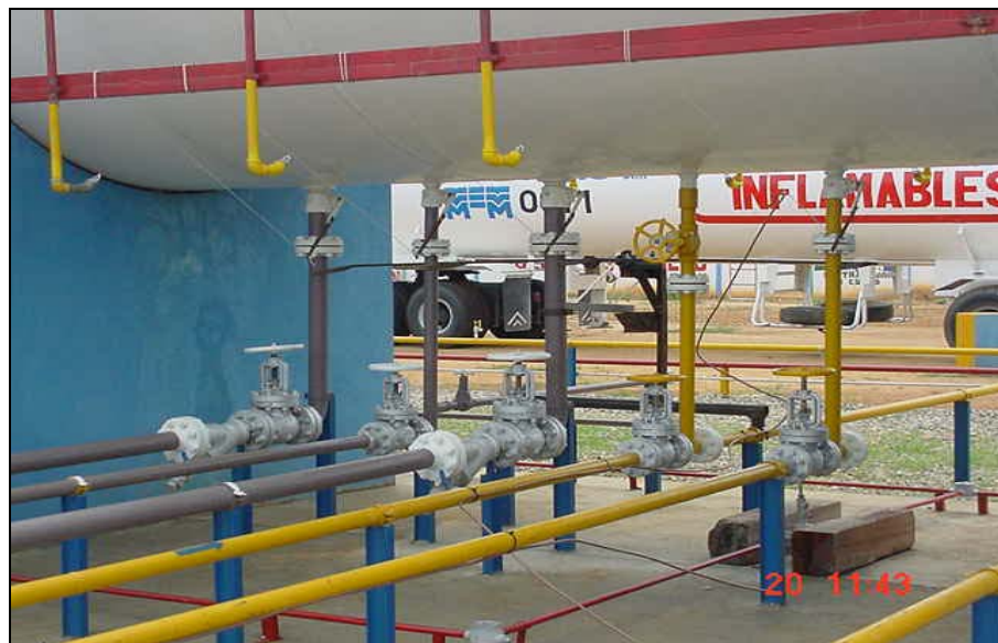
Foto N° 10 Conexión de las Líneas de Flujo
