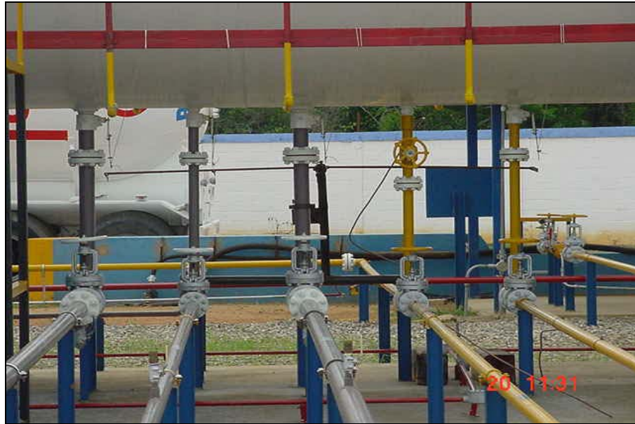
Foto N° 9 Conexión de las Líneas de Flujo
