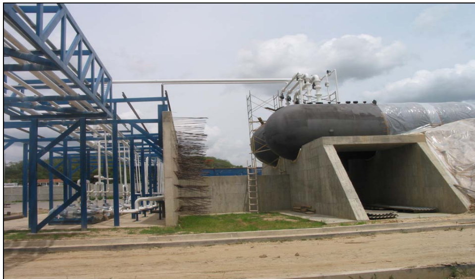
Foto N° 24 Conexiones de Alimentación y Suministro de GLP
