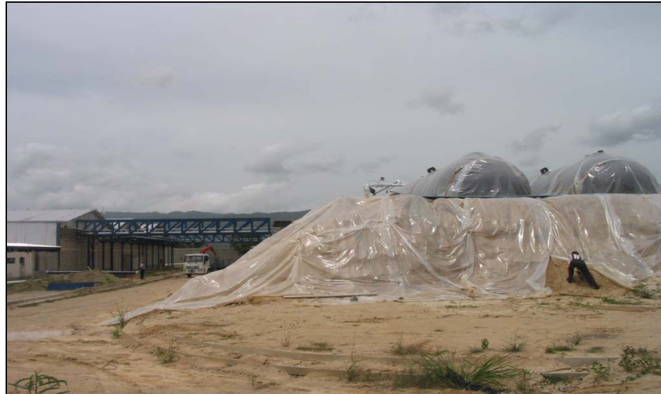
Foto N° 23 Tanques de Almacenamiento Soterrados o "Mounded"
