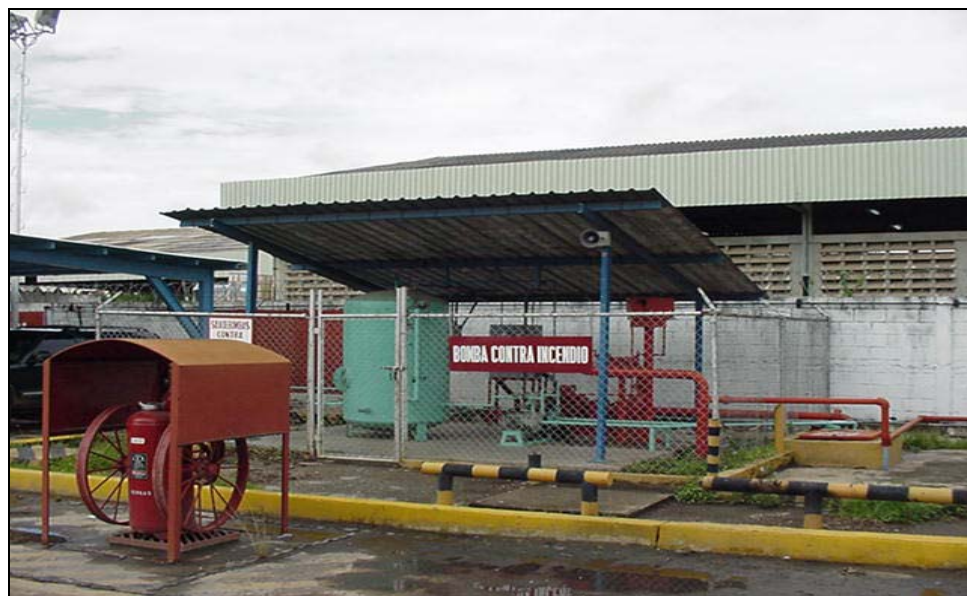
Foto N° 18 Bomba Contra Incendio
