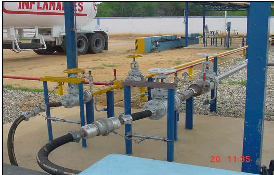
Foto N° 3 Bocas de trasiego de GLP
