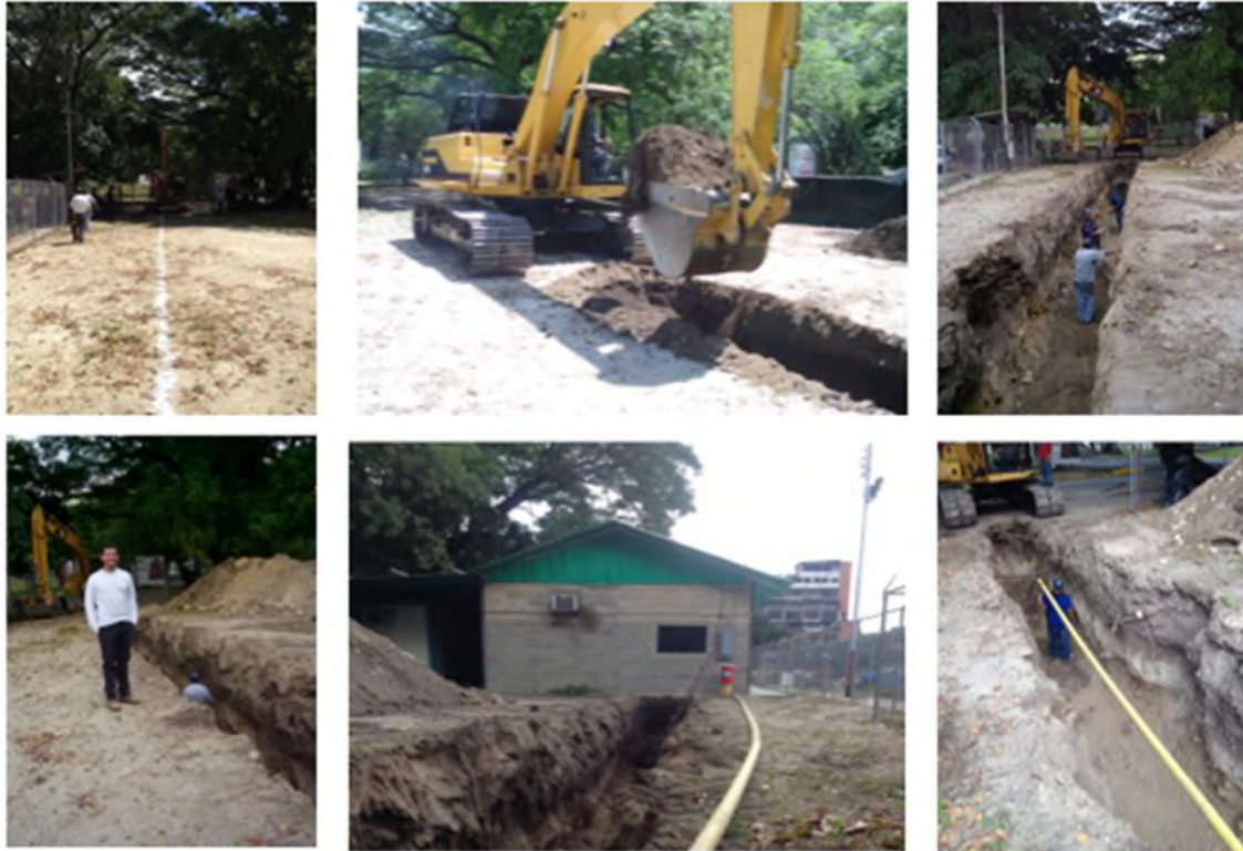
Figura 4. Realización de la zanja y colocación de los tubos. Fuente: Elaboración propia.
