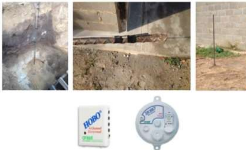
Figura 2. Proceso de excavación y colocación de los sensores para el registro de la temperatura del suelo.
