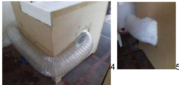
Figuras N°4 y 5. Ductería en módulo ventilado. Fuente: elaboración propia.
