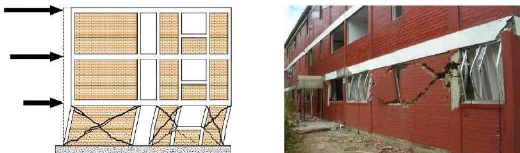
Figura 4: Comportamiento de edificaciones de mampostería confinada ante cargas en el plano: acciones sísmicas y daño esperado (izquierda), y daño ocurrido durante un terremoto (derecha). Tomado de Meli et al. (2011).
