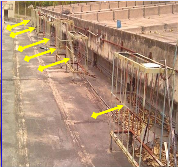
Imagen 13. Material propio. Fernández, H. (2019). Techo del CDIHP Rejas Vandalizada, se llevaron los 06 compresores del AA ubicado en el techo.
