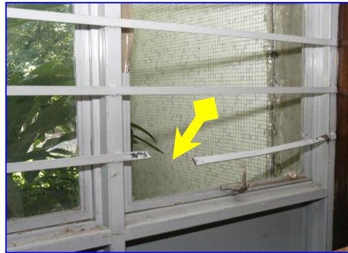
Imagen 27. Material propio. Fernández, H. (2019). Ventana de la sala N° 1 dañada por el vandalismo.
