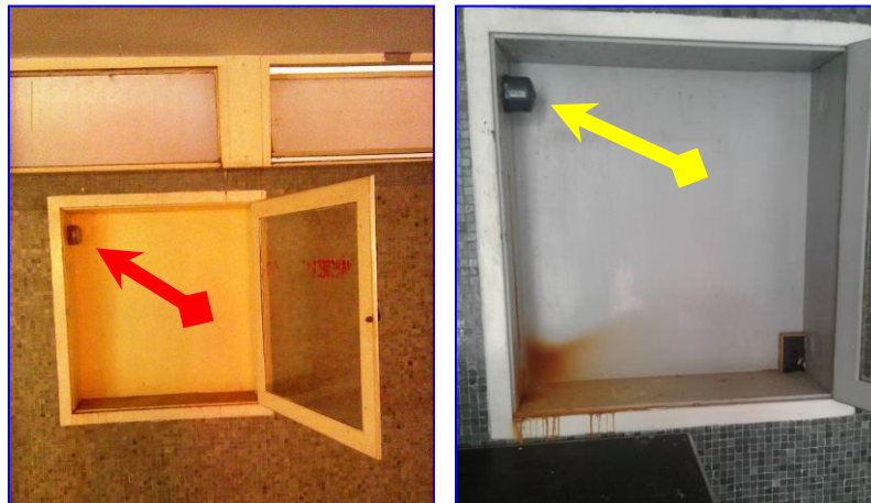
Imagen 46. Fuente propia. Fernández H. (2019). Gabinetes sin las mangueras plegables de alta presión, las cuales fueron hurtadas en el año 2017.
