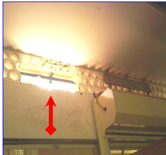
Imagen 15. Material propio. Fernández, H. (2019). Sala N° 1 se observa como el vandalismo rompió la colmena.
