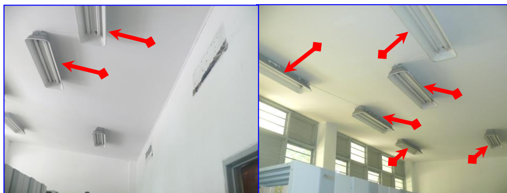
Imagen 39. Fuente propia. Fernández H. (2019). Las lámparas en la sala N° 2 y 3 no tienen mallas o protectores UV.
