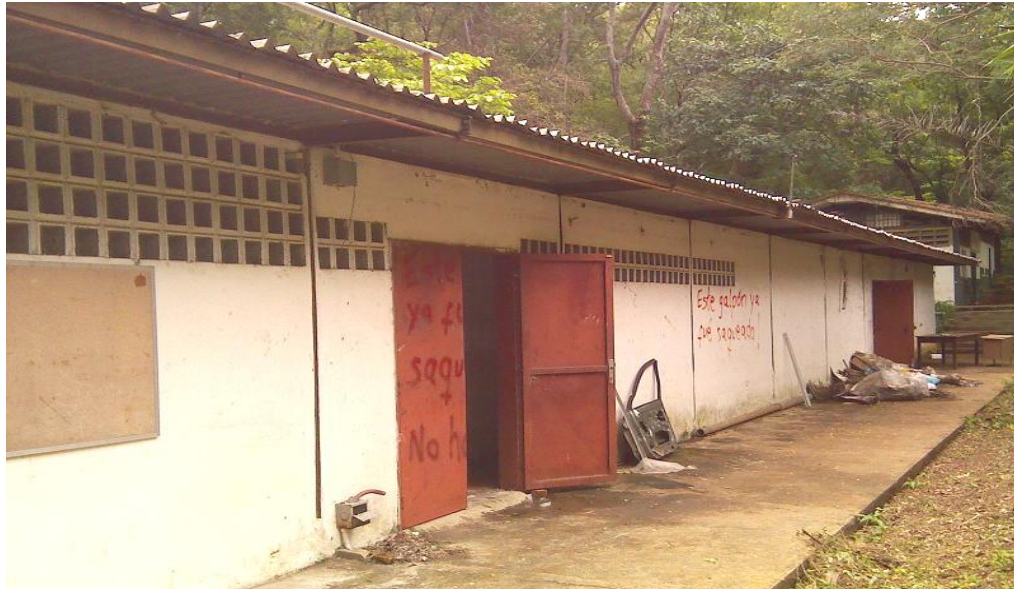
Imagen 52. Material propio. Fernández H. (2020). Galpón ubicado a 25m del edificio sede que se ve al fondo en color rojo. Se puede recuperar y remodelar para instalar Centro de Comando, Control y Telecomunicaciones VEN-911.
