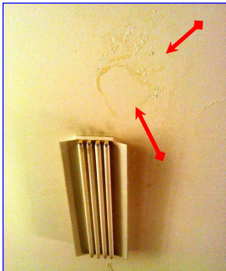
Imagen 14. Material propio. Fernández, H. (2019). Sala N° 1 presenta filtración en el techo.
