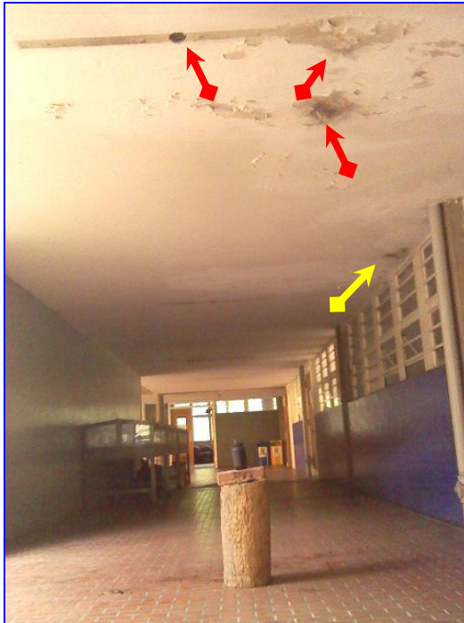
Imagen 12. Material propio. Fernández, H. (2019). Interior del Edificio se observa filtraciones
