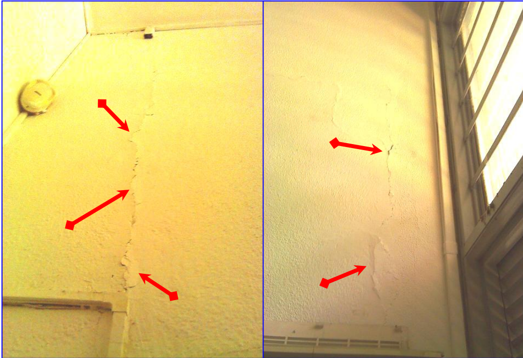
Imagen 16. Material propio. Fernández, H. (2019). Interior del CDIHP sala N° 2 se observa como las paredes presentan grietas producto de la humedad y por el desplazamiento del edificio.
