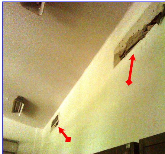
Imagen 18. Material propio. Fernández, H. (2019). Sala N° 3 del CDIHP pared donde estaban las consolas del AA fue dañada.
