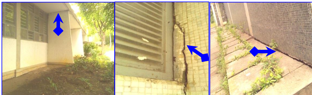
Imagen 11. Material propio. Fernández, H. (2019) Condiciones de la infraestructura, se observa fractura en paredes, suelo y techo.
