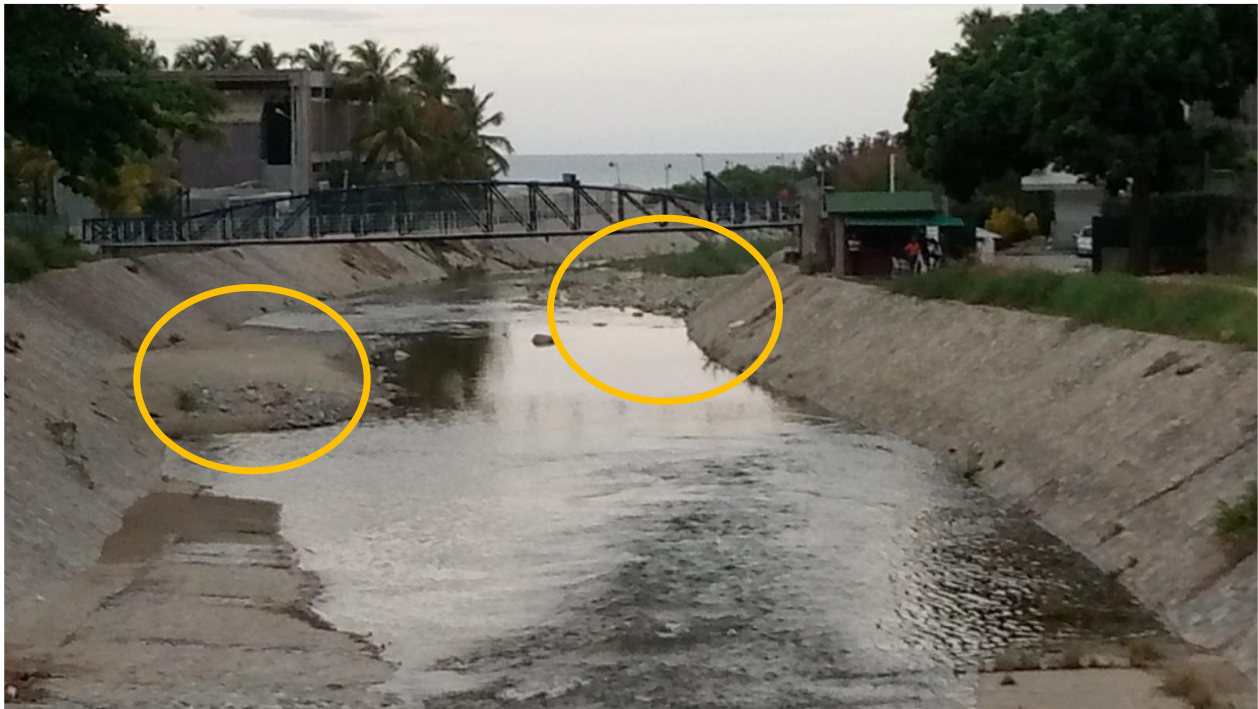
Figura 26. Tramo inferior de la canalización en concreto del río Camuri Grande, vista hacia aguas abajo desde el puente en la Av. Costanera, mostrando acumulaciones de sedimentos en el lecho que explican las perturbaciones superficiales y los desbordes que ocurrieron hacia el Club Camurí Grande (foto del 12-09-2021).
