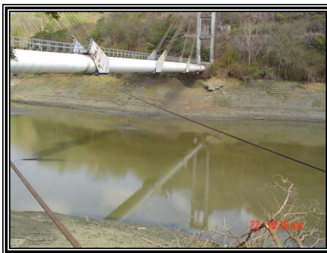
Foto N° 2: Tubería del Sistema Tuy III
