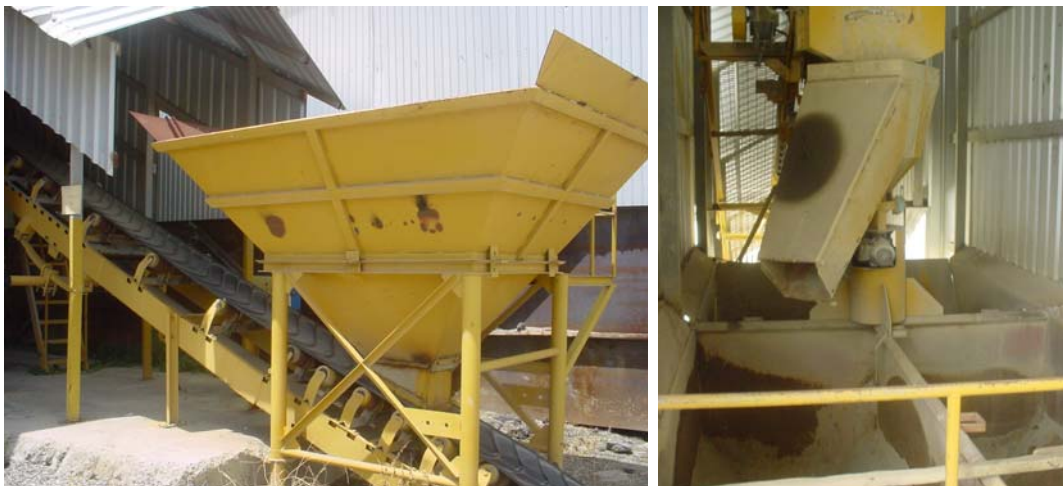
Figura 101. Izquierda: Tolva de vaciado de arena y piedra y cinta transportadora, derecha: Tanques de clasificación y almacenamiento.
