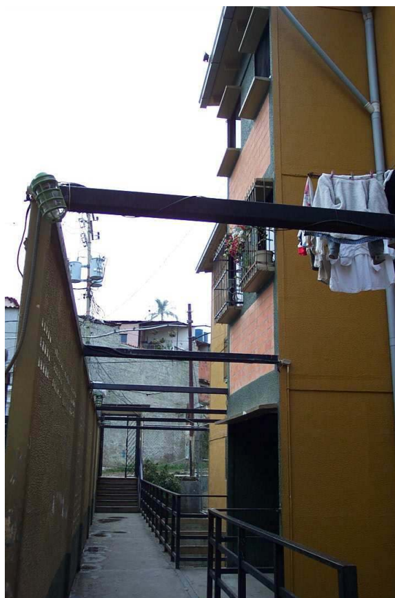
Espacios internos de los edificios “Unión Catuche” Foto: José Michelli / Daniel Maggi
