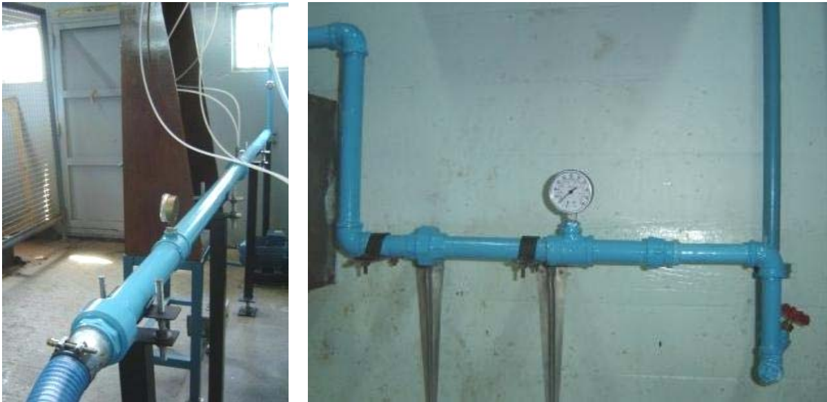
Figura 42. Líneas de suministro de aire: izq. zona cercana al banco de ensayos. Der. zona interna del laboratorio de Transferencia de Calor de la EIM de la UCV
