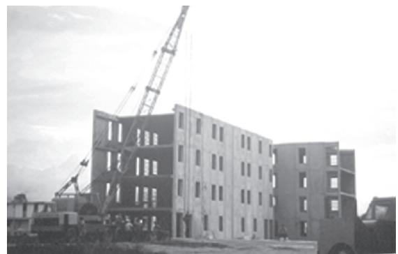
Foto 3 Sistema A4 de Vivienda Venezolana. Paredes portantes de 12 m de altura para edificios de hasta 4 pisos y losas prefabricadas. Foto: archivo IDEC.
