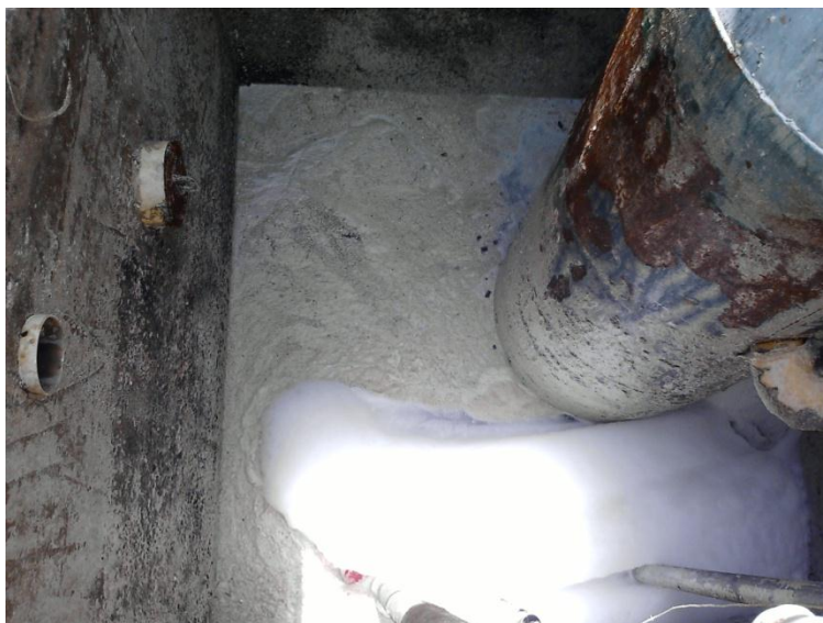
Figura N° 35: Nivel de la tanquilla de bombeo N° 1 y tuberías de enlace con la tanquilla de bombeo N° 2
