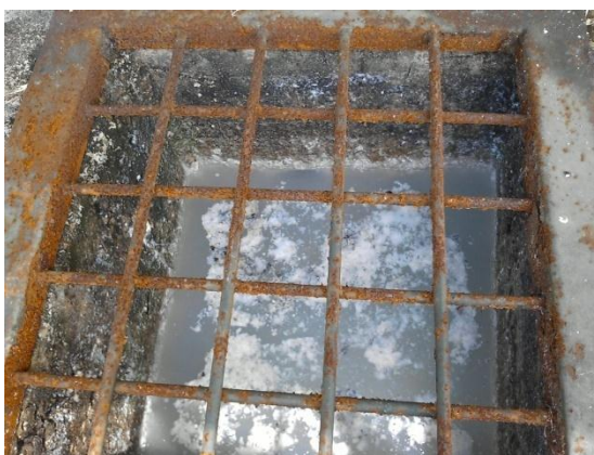
Figura N° 41: Tanquilla de drenaje de los Lechos de Secado, cuando el nivel del líquido está por encima de las salidas de las tuberías que conectan con dichos lechos
