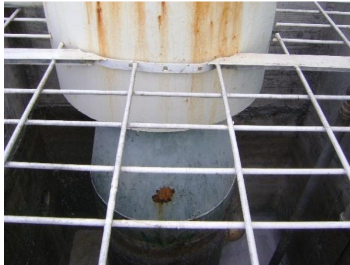
Figura N° 12: Partes del Separador de Espuma de la PTARI
