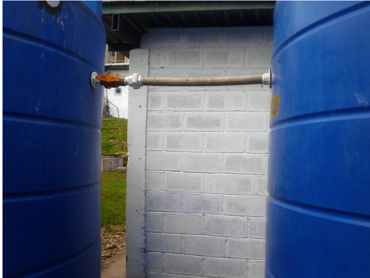
Figura N° 37: Conexión entre los tanques de Balance / Aireación de la PTARI
