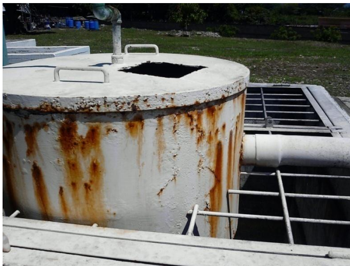
Figura N° 32: Corrosión en el recolector del Separador de Espuma
