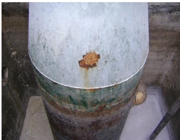
Figura N° 33: Corrosión en el ducto del Separador de Espuma
