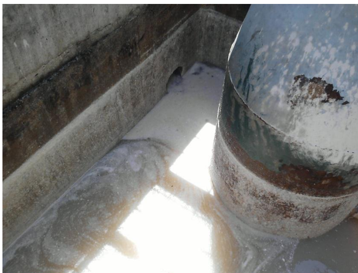
Figura N° 39: Tubería que conecta la tanquilla N° 1 con la tanquilla de drenaje de los Lechos de Secado
