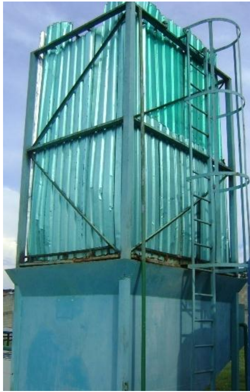
Figura N° 14: Filtro Bio-percolador y Sedimentador Secundario de la PTARI
