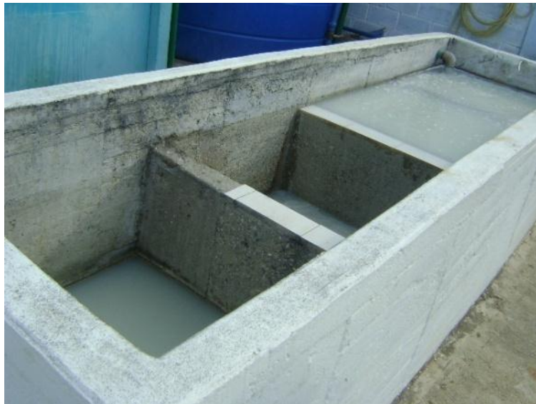
Figura N° 16: Tanque de Desinfección o Clorinador de la PTARI
