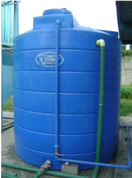
Figura Nº 13: Primer tanque de Balance / Aireación de la PTARI
