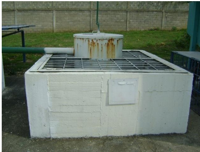
Figura N° 11: Tanquilla de Bombeo N°1 de la PTARI
