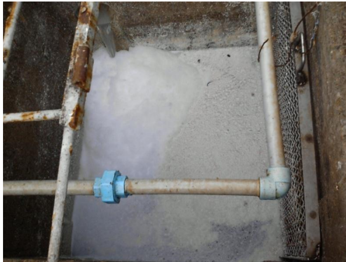
Figura N° 10: Tanquilla de Desbaste de la PTARI
