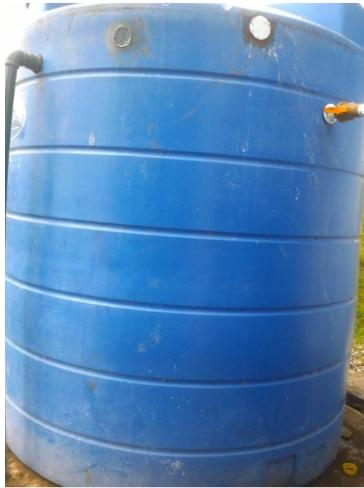
Figura N° 38: Segundo tanque de Balance / Aireación de la PTARI
