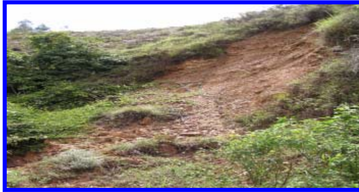
Figura 45. Movimientos complejos (caída de bloque, flujo de detritos y deslizamiento translacional) (Azimut 10°- Carite).
