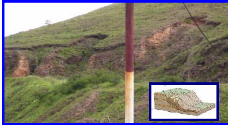
Figura 39. Deslizamiento rotacional (Azimut 85°- Altos de Pipe).
