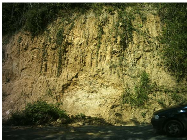
Figura 42: Flujo de Lodo, ubicado en la carretera hacia Urama (pto 147), se observa la geometría de la corona muy irregular estando asociado a un talud de gran pendiente donde aflora un suelo residual. (rumbo de la foto N25°E)
