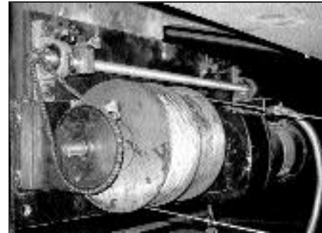
Figura 33 Motor y sistema de control
