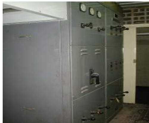
Fig. 3. Tablero central de alimentación
