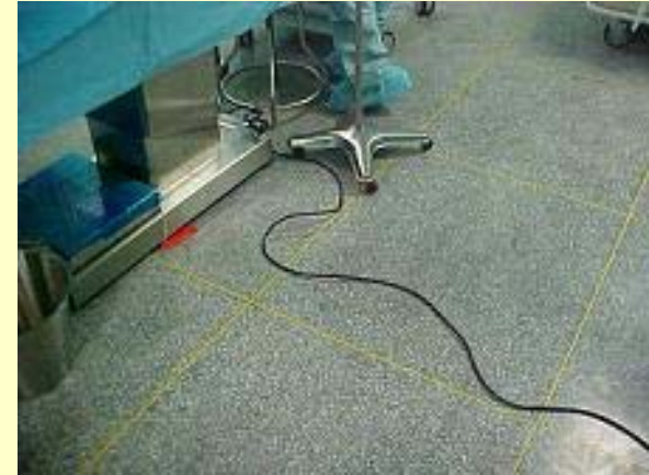
Cables y mangueras de alimentación de la máquina de anestesia.
