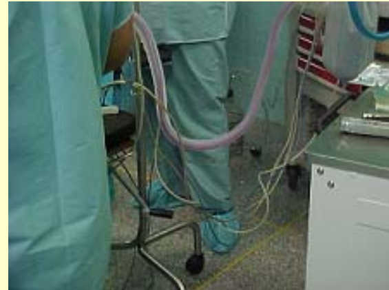
Cables y mangueras dispuestos arbitrariamente.
