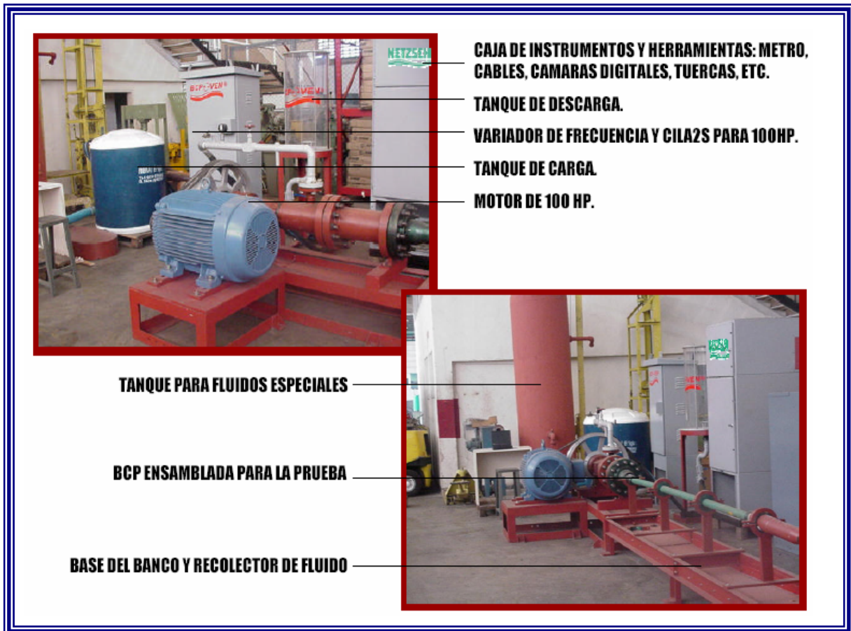
Figura 3.1.- Banco de Prueba Ensamblado.
