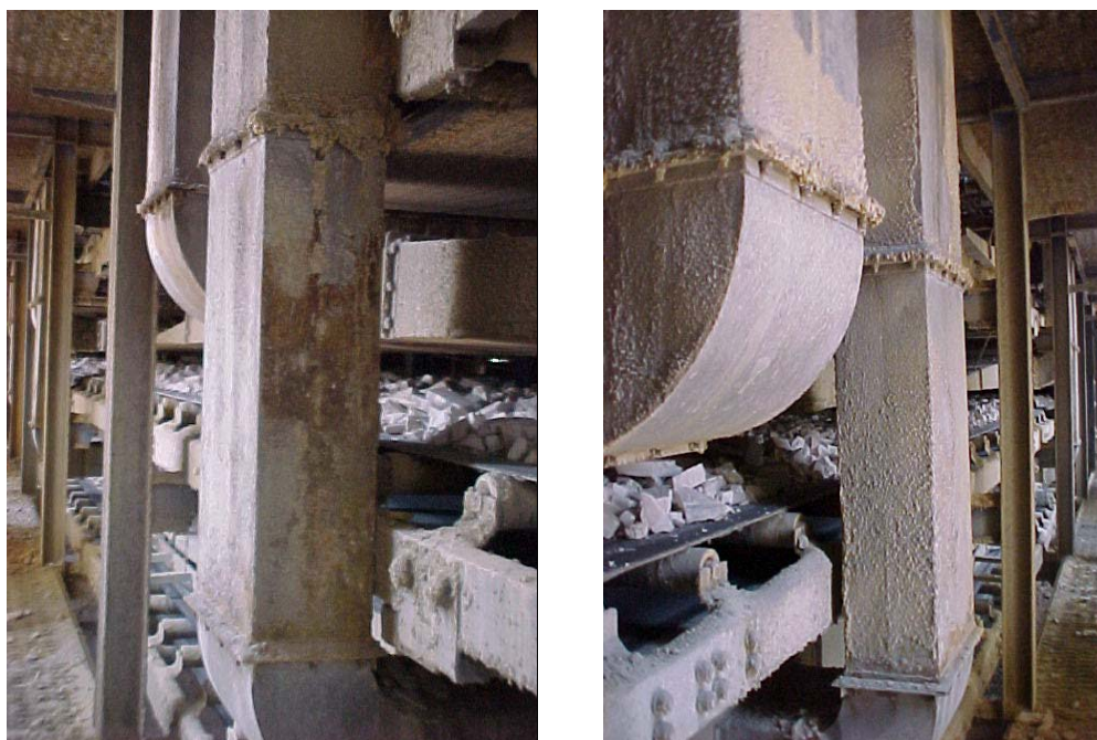
Figura N° 5.11 Corrosión y suciedad en ductería.
