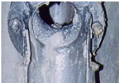
Figura N° 5.6 Detalle: brida de salida No. 1 de la mezcladora
