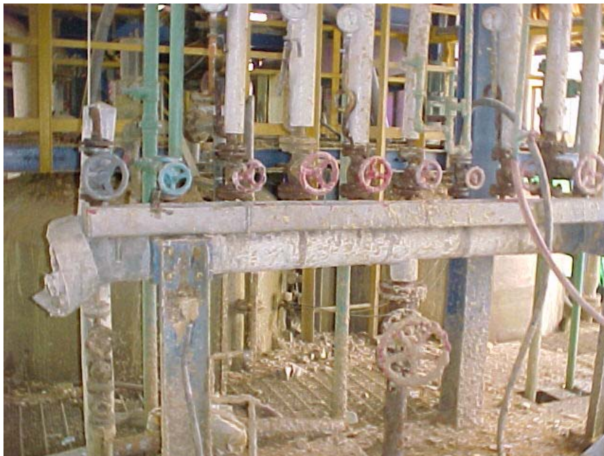
Figura N° 5.3 Distribuidor de vapor No. 2
