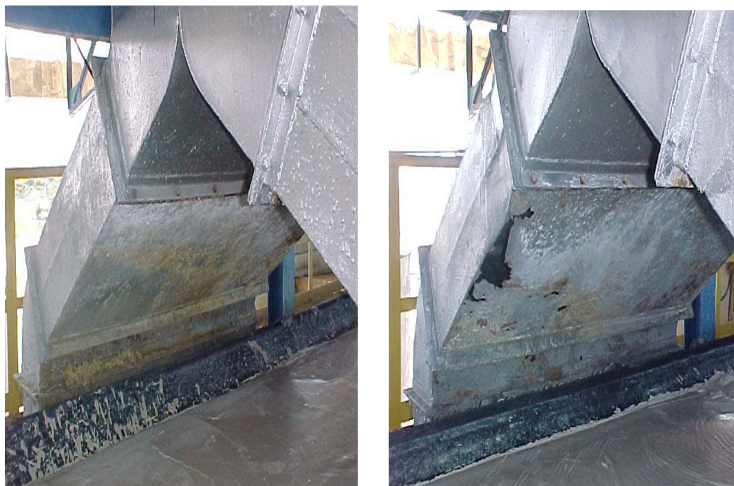
Figura N° 5.12 Corrosión y orificio en parte superior de los ductos
