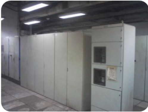
Fig. 5.43. Sala de PLC del Área de Reducción 420
