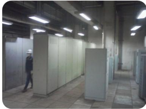
Fig. 5.44. Sala de MCC del Área de Reducción 420
