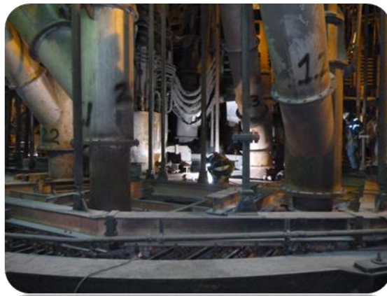
Fig. 2.2. Techo o Bóveda del Horno de Reducción L2
