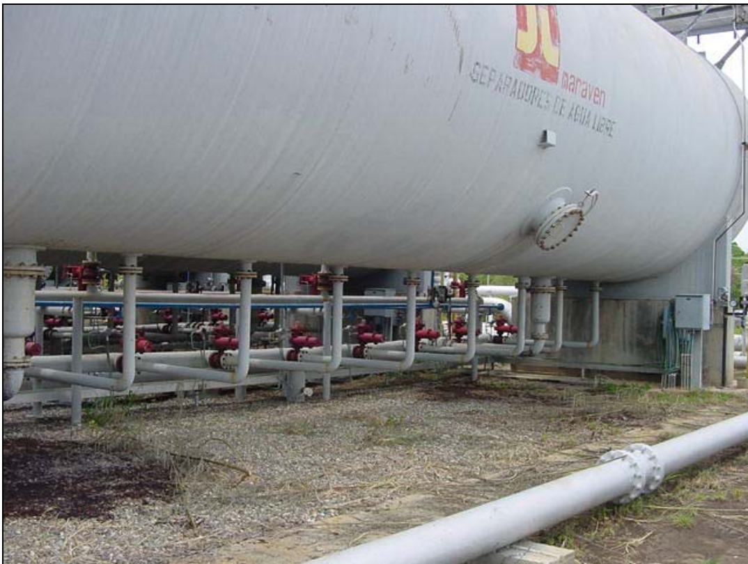
Figura 5.5.-Vista de las Tuberías de Inyección de Agua para el Sistema de Limpieza.
