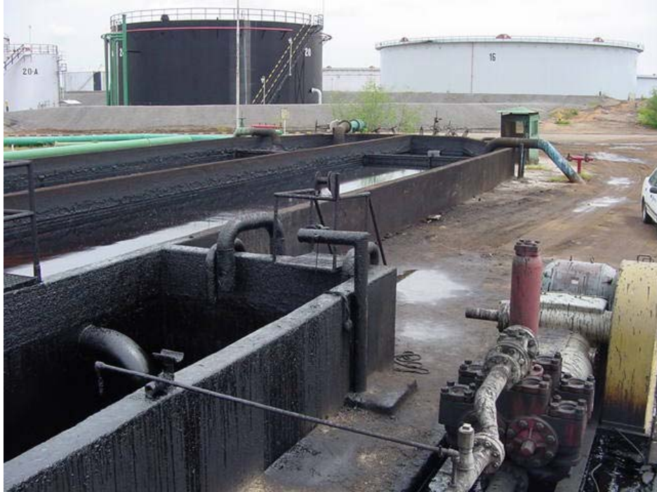
Figura 2.7.-Separador API Sur del Patio de Tanque Bachaquero
