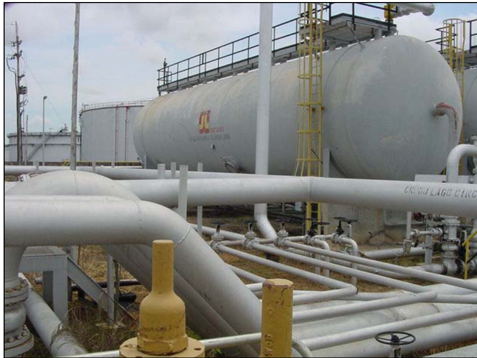
Figura 5.1.- DAL Horizontal, Patio de Tanques de Bachaquero
