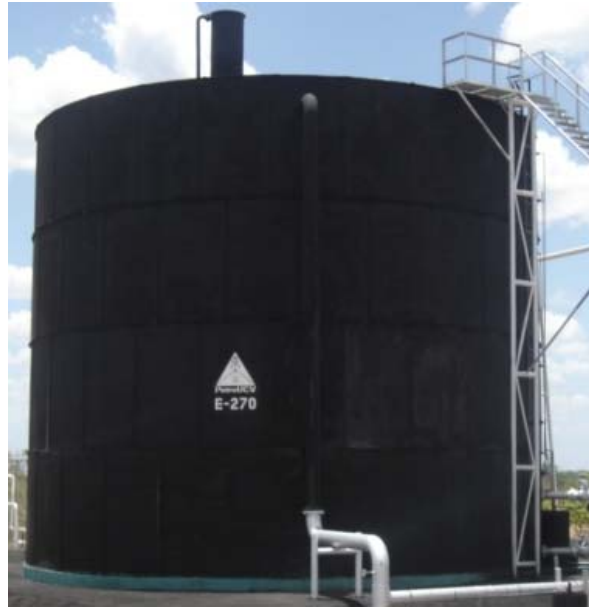
Figura. 5.4. Tanque de lavado de EEF-11.
