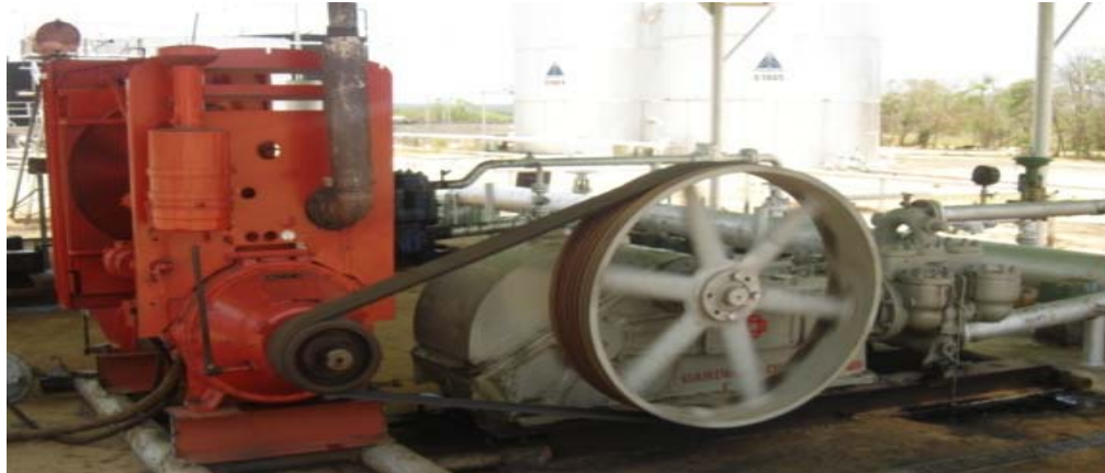
Figura. 5.8. Bomba de transferencia de crudo de EEF-11.
