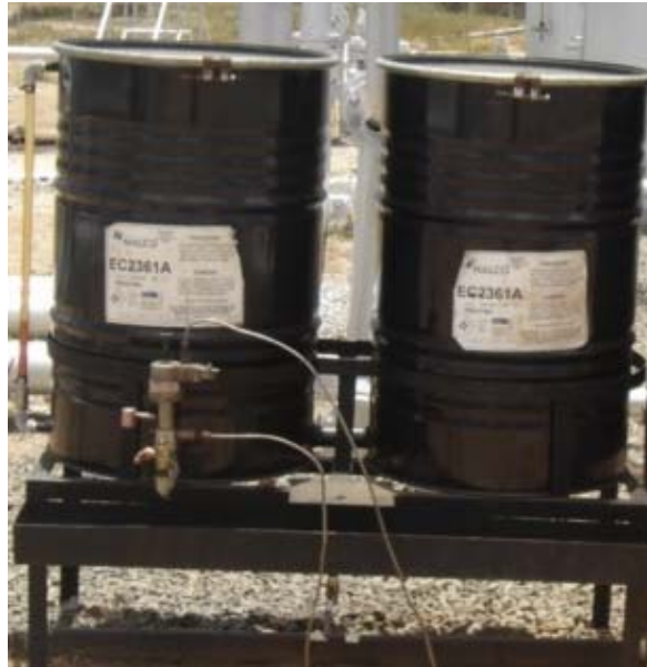
Figura. 5.9. Bombas de inyección de química.
