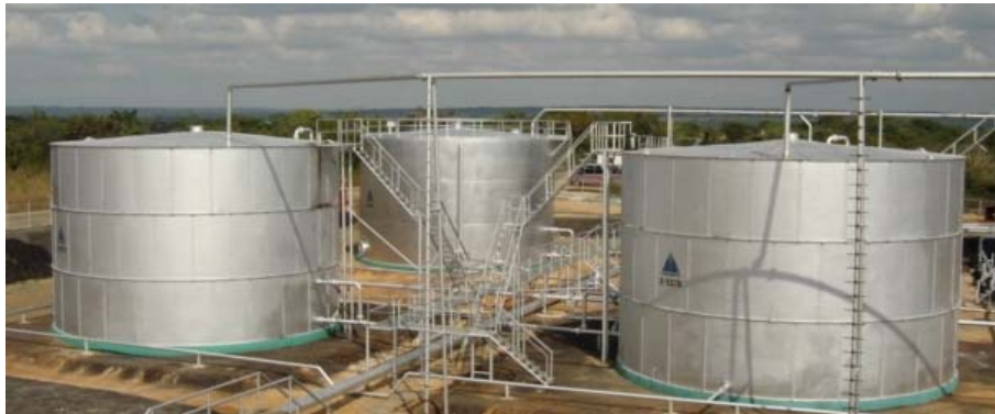
Figura. 5.5. Tanques de almacenamiento de crudo de EEF-11
