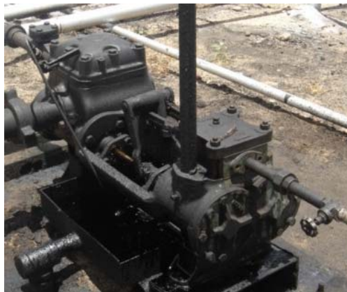
Figura. 5.7. Bomba de circulación de crudo de EEF-11.
